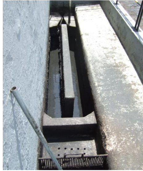
2. Caixa de areia e medição de vazão
