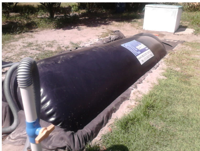
Figura 4.24: Biodigestor com biogás.
