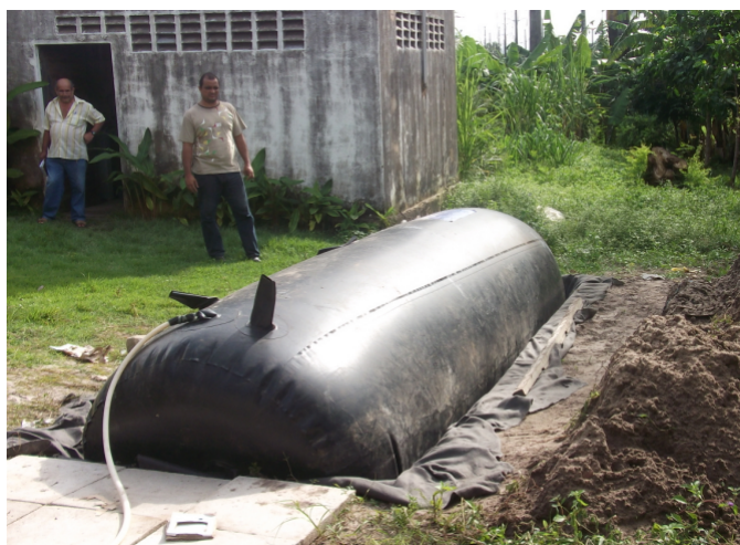
Figura 4.16: Biodigestor semi enterrado
