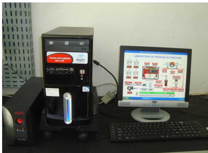
Figura 4.25: Sistema de monitoramento da planta de biogás.
