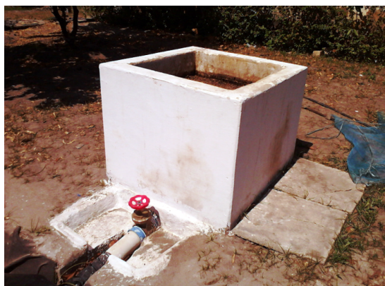
Figura 4.17: Caixa de entrada do biodigestor.
