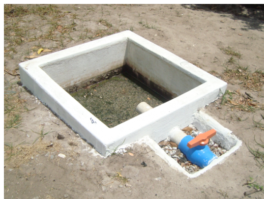
Figura 4.18: Caixa de saída do biodigestor.
