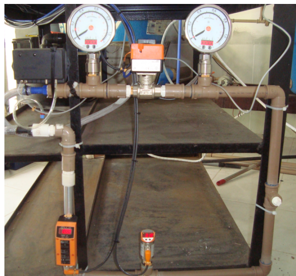
Figura 4.2: Unidade de controle de vazão da planta de biogás.
