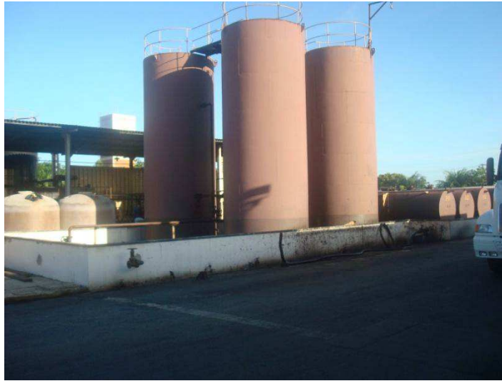
Figura 38 – Tanques de armazenamento de emulsão asfáltica na Asfaltos Nordeste
