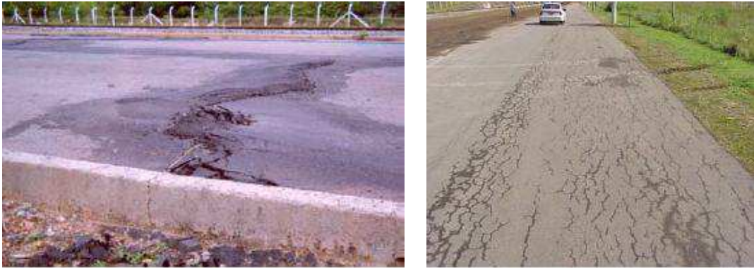
Figura 30 – Problemas em revestimentos devido à expansão do AS
