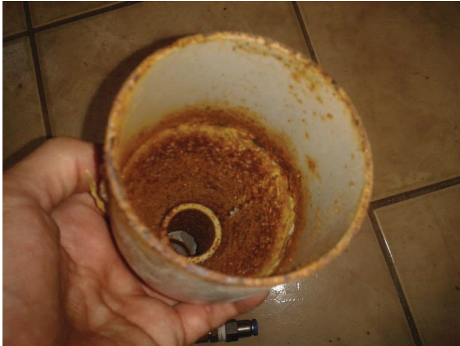
Figura 39 — Vista superior do tubo de exaustão de gases de combustão
