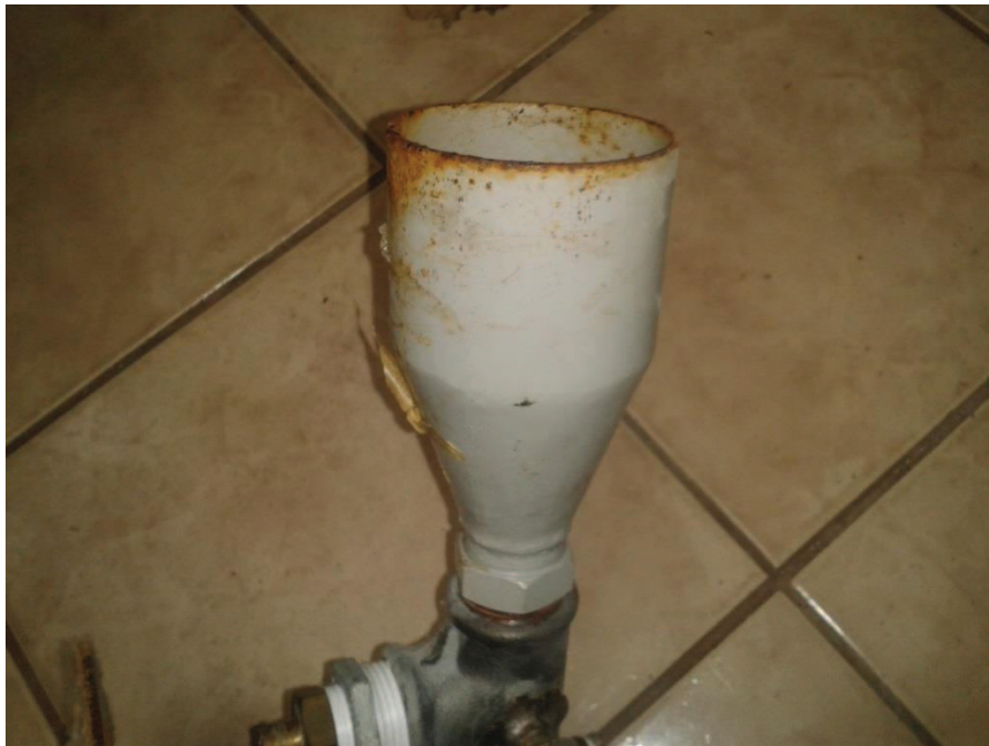
Figura 38 — Tubo de exaustão dos gases de combustão do queimador
