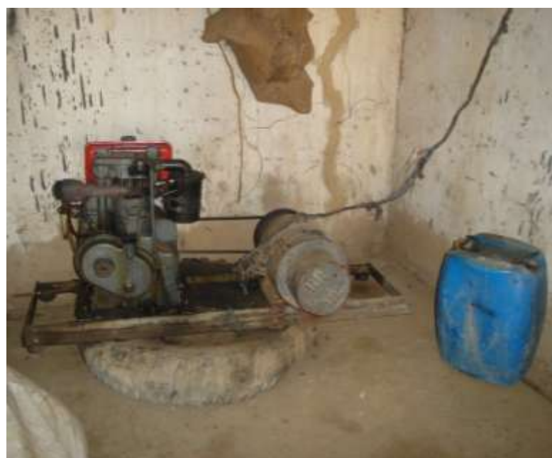
Figura 33 - Grupo-gerador a diesel em residência na Comunidade Malícia, Uruçuí – PI
