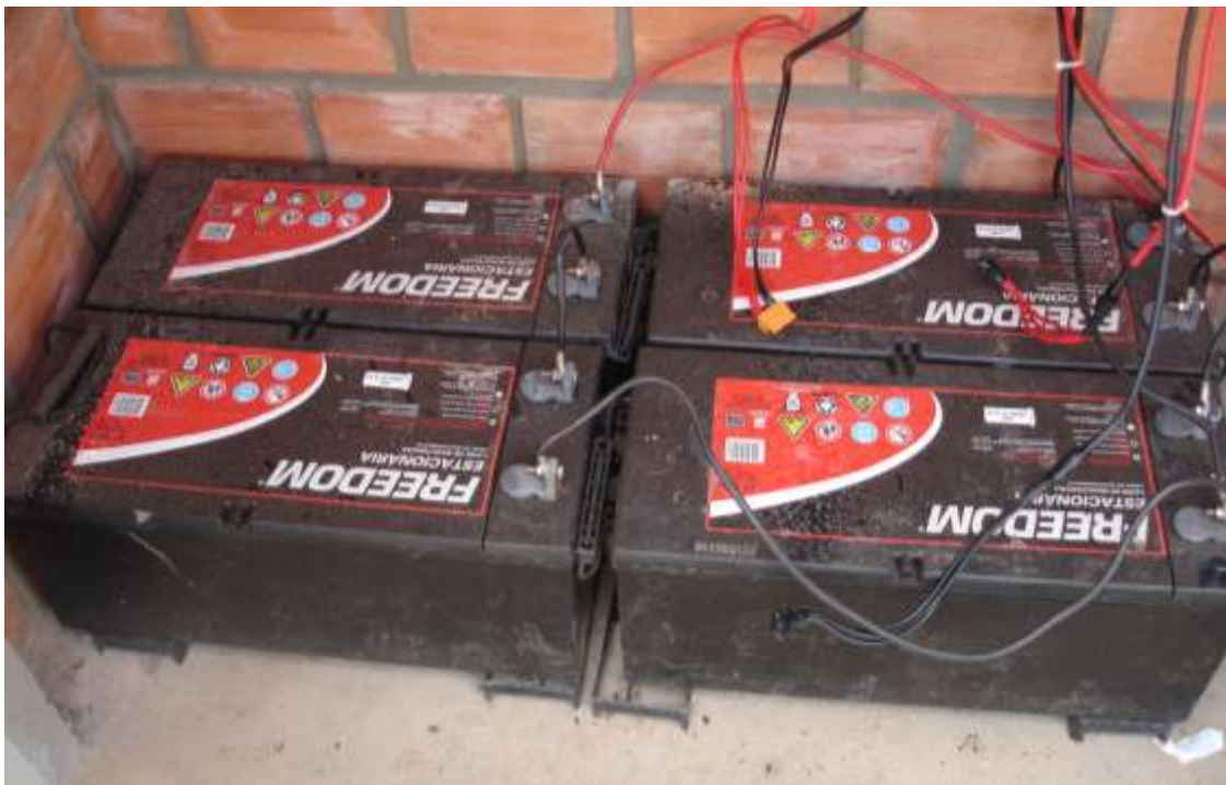
Figura 40 - Banco de Baterias do Sistema na comunidade Malícia – Uruçuí-PI
