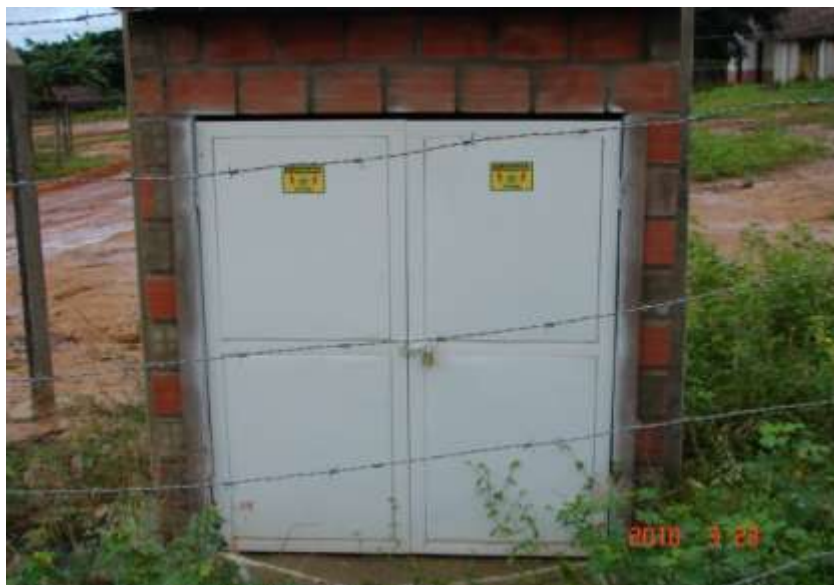
Figura 52 - Cubículo com baterias, carregador de baterias e conversor elevador – Localidade Malícia
