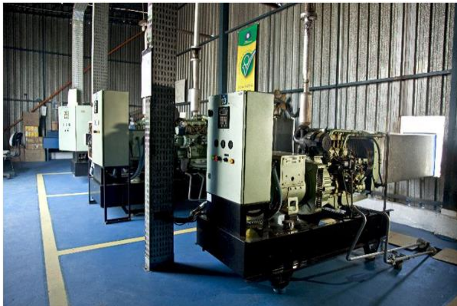
Figura 3.4 - Grupo Gerador diesel do sistema híbrido de Araras – RO.
