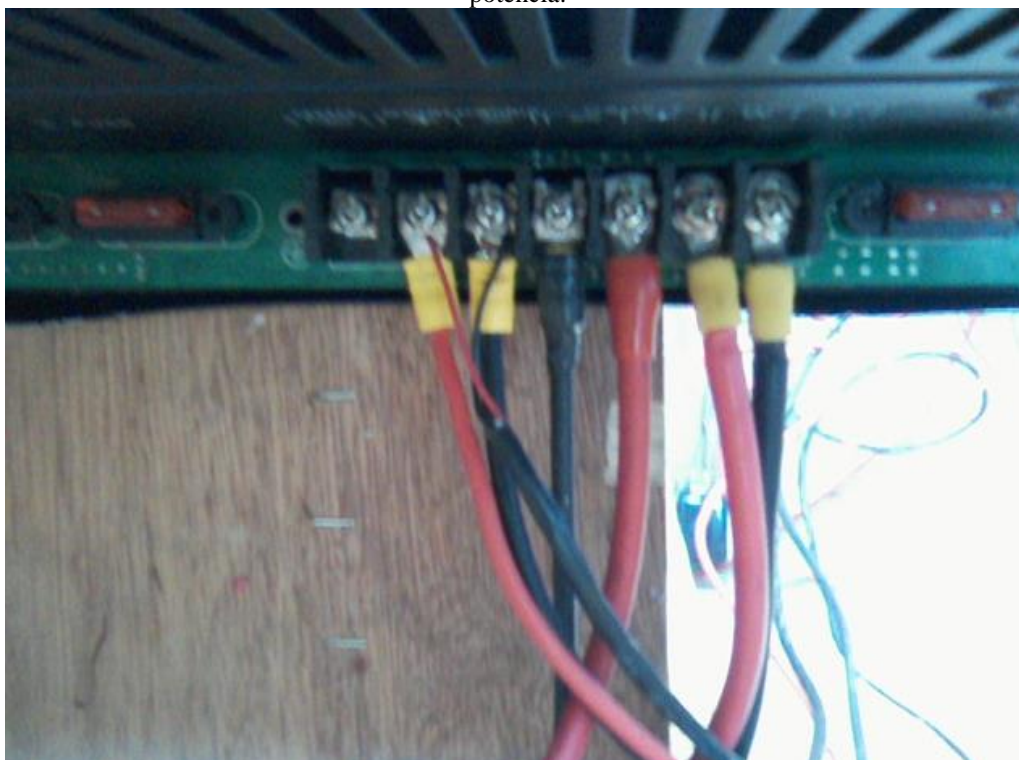
Figura 9.8 – Conexão das unidades de conversão, banco de baterias e sensor ao sistema de condicionamento de potência.
