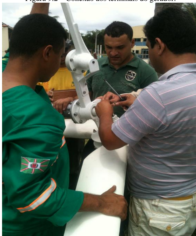
Figura 9.2 – Conexão aos terminais do gerador.
