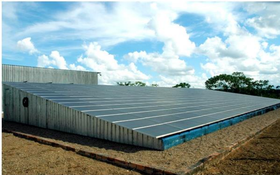
Figura 3.3 – a) Arranjo FV Araras – RO; e b) Sistema de condicionamento de potência do arranjo FV
