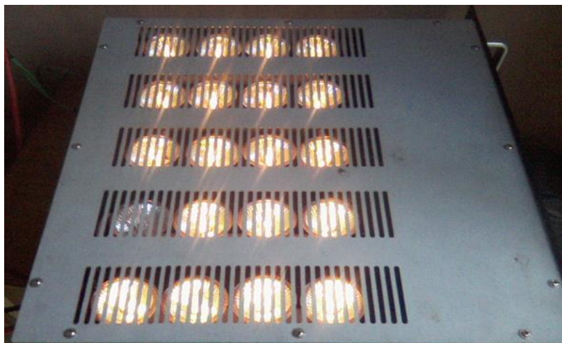
Figura 4.10 - Lâmpadas usadas para dissipação de excedente de energia ( dump load ).
