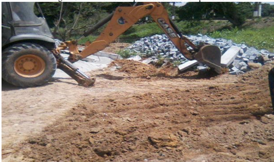
Figura 5.41 – Atividade que ocasionou o rompimento.
