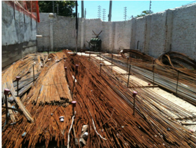
Figura 41 - Ferragens oxidadas pela ação de intempéries devido a estocagem inadequada
