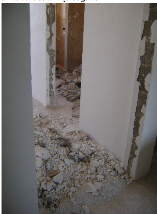
Figura 66 - Acumulo indevido de resíduos de serviço de gesso
