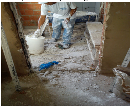
Figura 82 - Falta de lona plástica na execução de serviço com gesso
