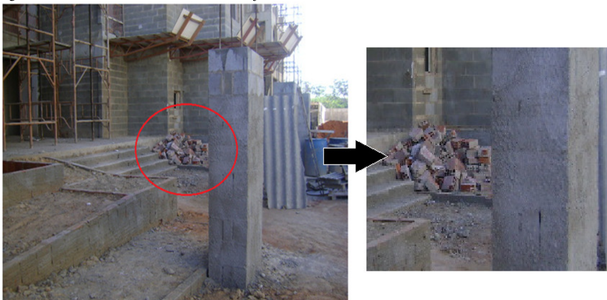
Figura 68 - Acúmulo indevido de resíduos de tijolo cerâmico
