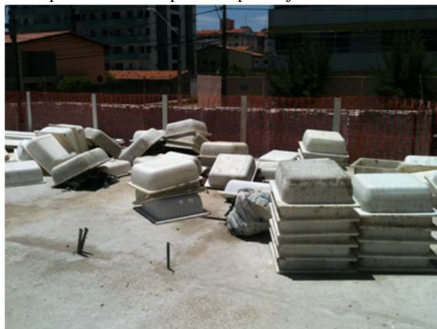
Figura 40 - Armazenagem inadequada de fôrmas plásticas para laje nervurada
