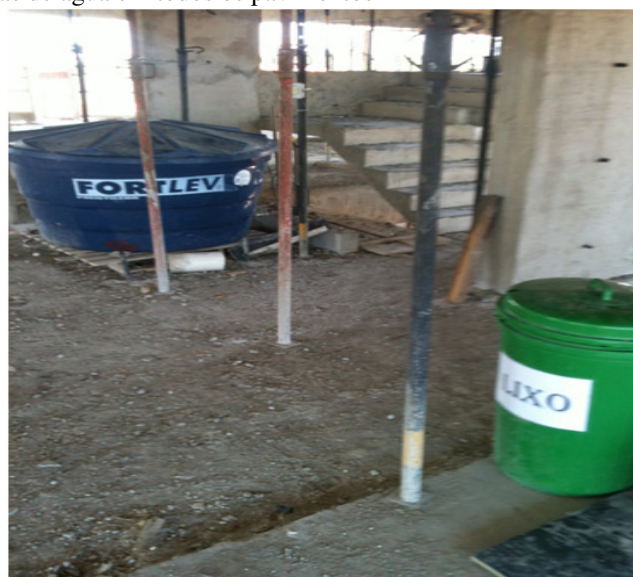
Figura 27 - Lixeiras e caixas de água em todos os pavimentos
