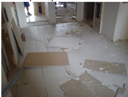
Figura 83 - Resíduos de gesso acartonado dispostos precariamente
