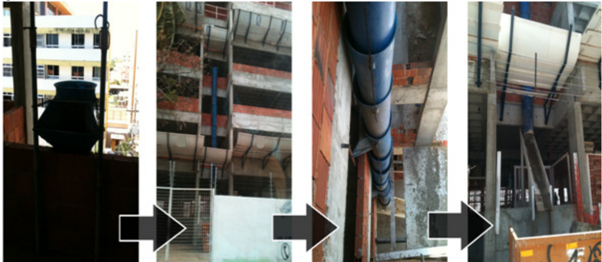
Figura 26 - Tubo coletor vertical de resíduos
