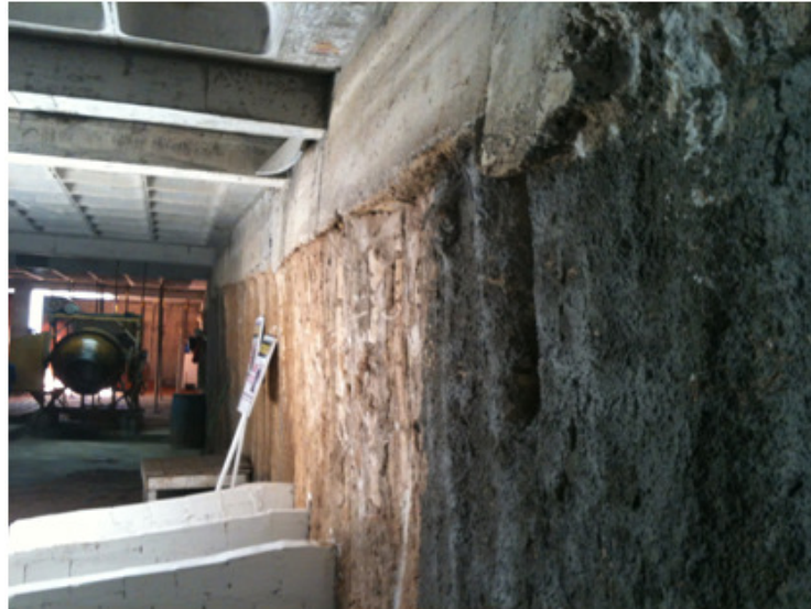
Figura 43 - Falha na execução de cortina de contenção do terreno
