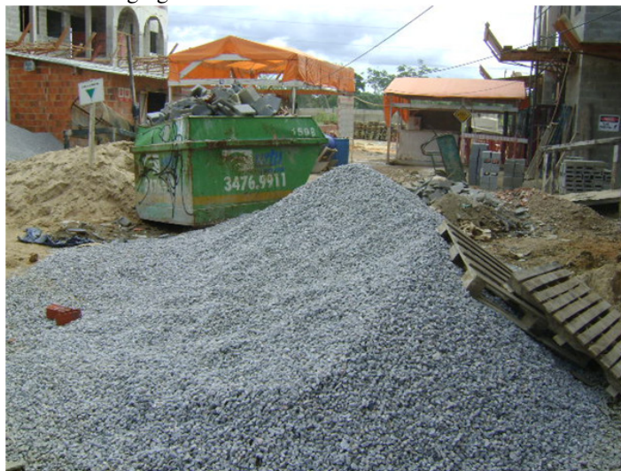
Figura 70 - Estocagem indevida de agregados e resíduos
