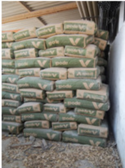
Figura 39 - Sacos de aglomerantes indevidamente estocados
