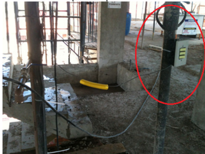
Figura 28 - Interruptor do sistema ANDON disposto nos pavimentos
