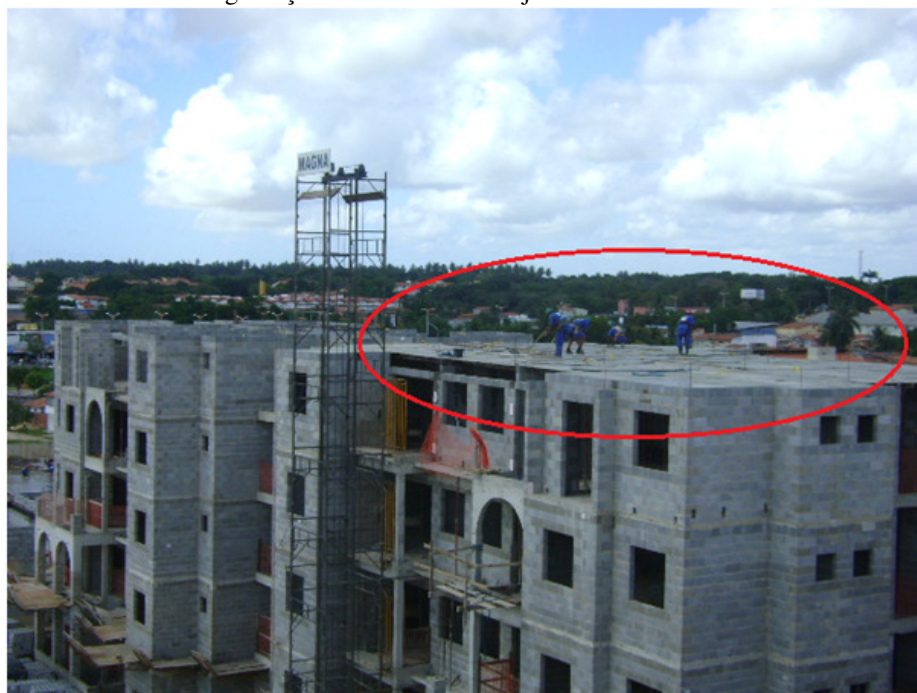
Figura 71 - Falha no sistema de segurança de isolamento da laje
