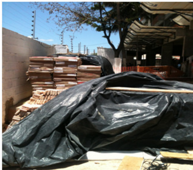
Figura 42 - Revestimento cerâmico indevidamente estocado
