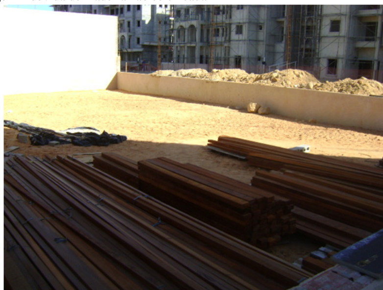
Figura 67 - Estocagem indevida de madeira não certificada
