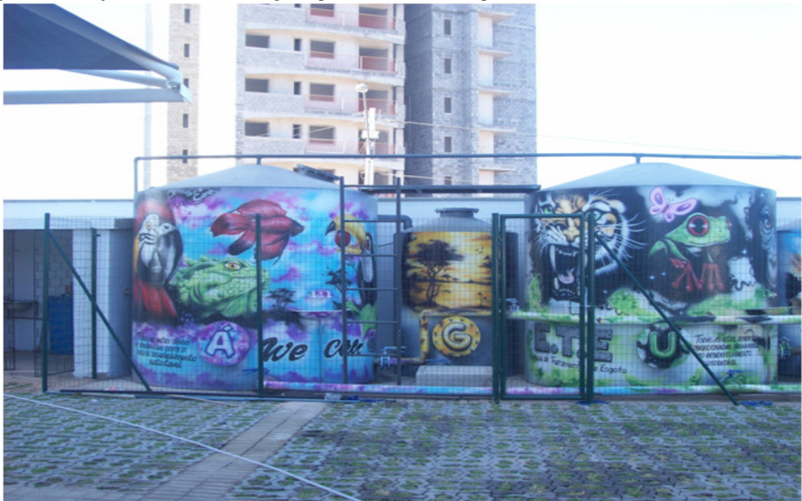
Figura 47 - Estação de tratamento de esgoto aparente da obra da empresa B
