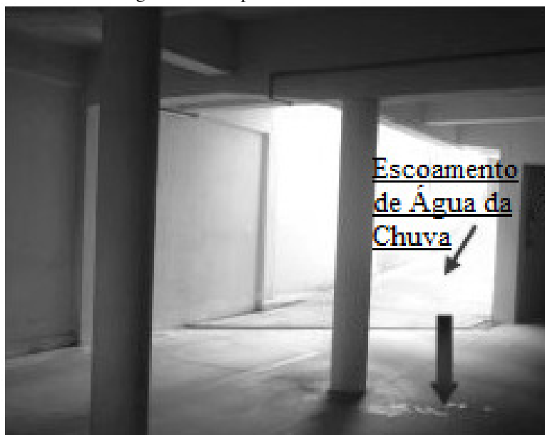
Figura 74 - Escoamento indevido de água da chuva para estacionamento
