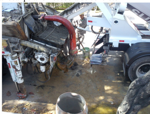
Figura 84 - Poluição gerada na via local pela fornecedora de concreto
