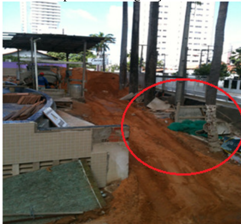
Figura 80 - Acúmulo inadequado de resíduos próximo a vegetação
