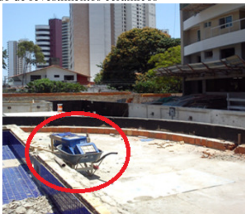
Figura 81 - Transporte inadequado de revestimentos cerâmicos
