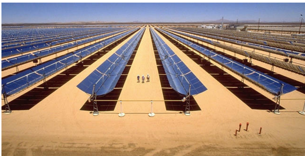
Figura 107 – Conjunto de coletores solar em forma de cilindro parabólicos
