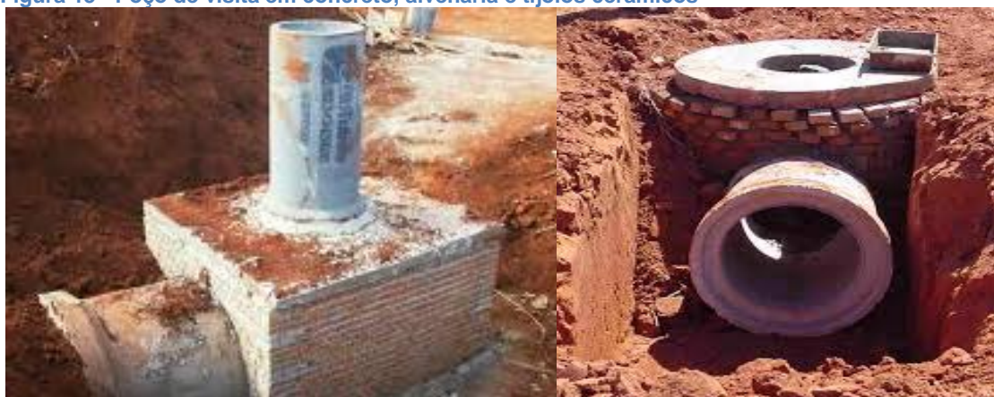
Figura 13 - Poço de visita em concreto, alvenaria e tijolos cerâmicos
