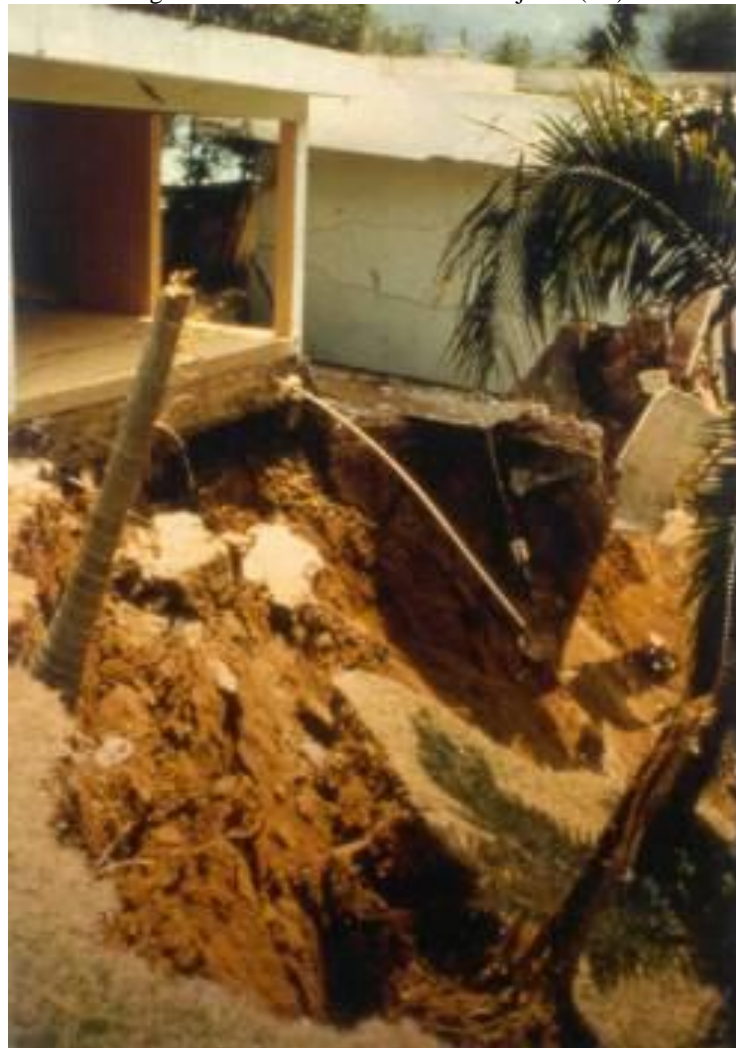
Figura 2.3c – Casas afundada em Cajamar(SP)
