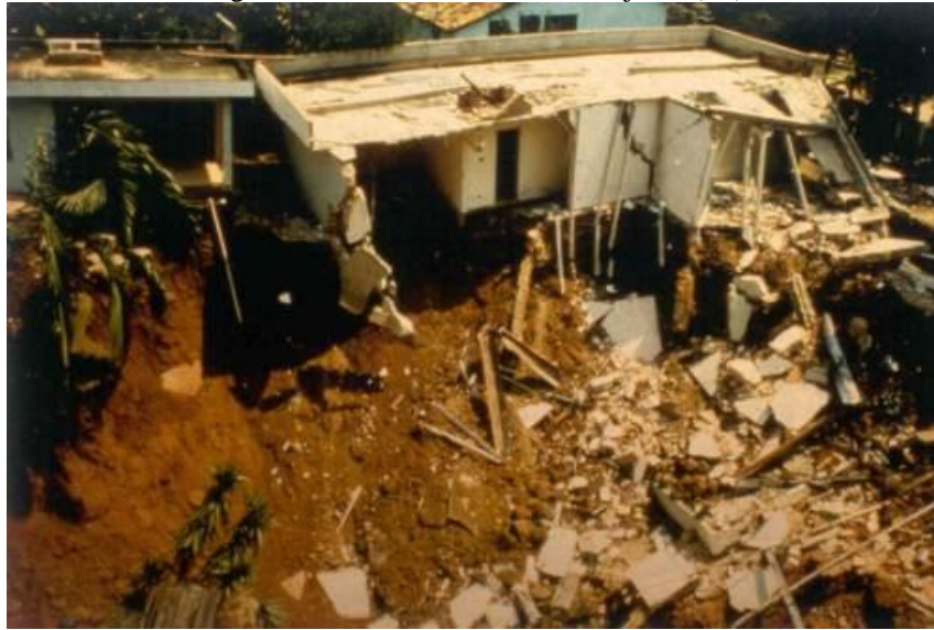
Figura 2.3b – Casa afundada em Cajamar(SP)
