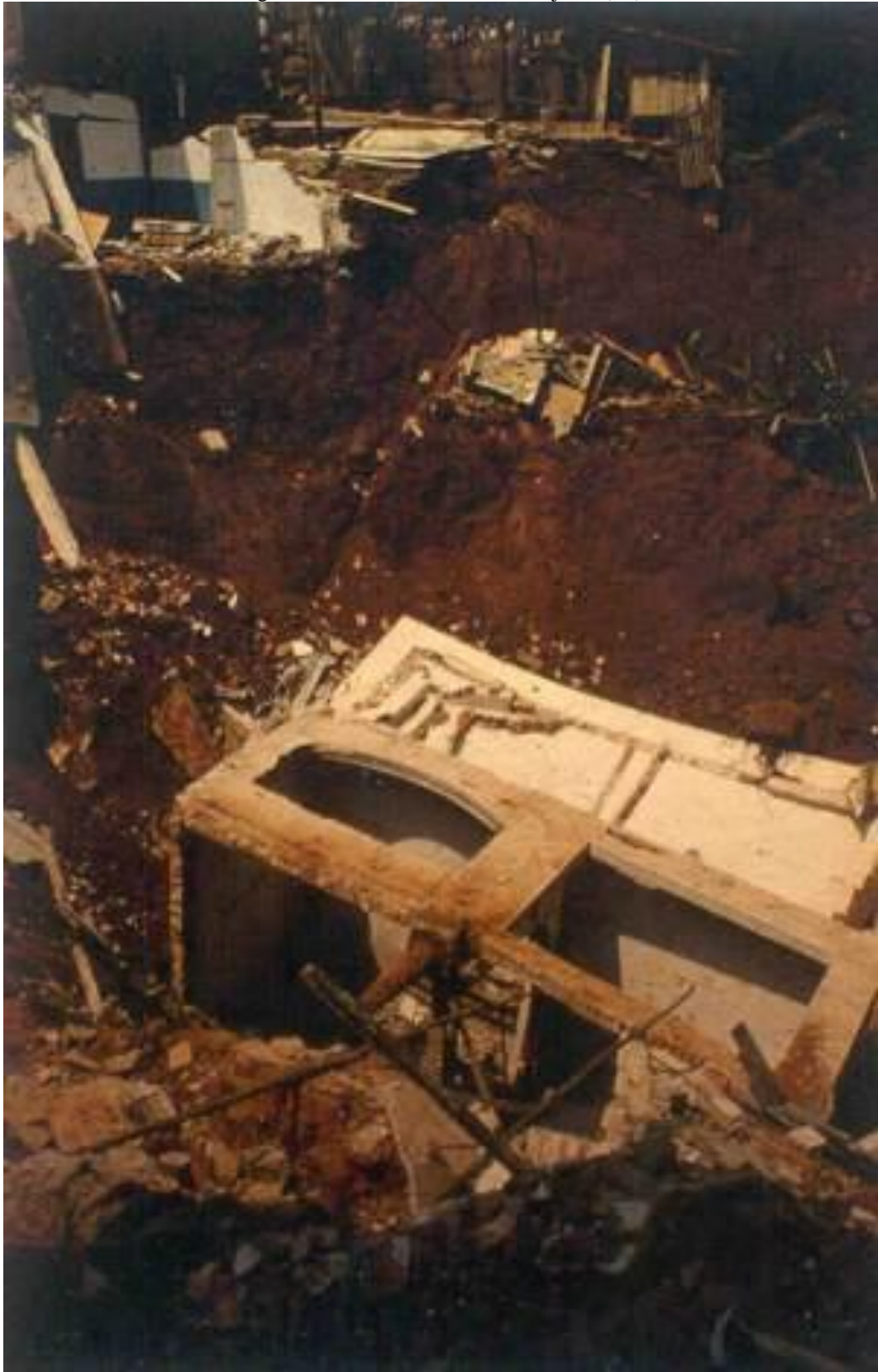
Figura 2.3a – Casa afundada em Cajamar(SP)
