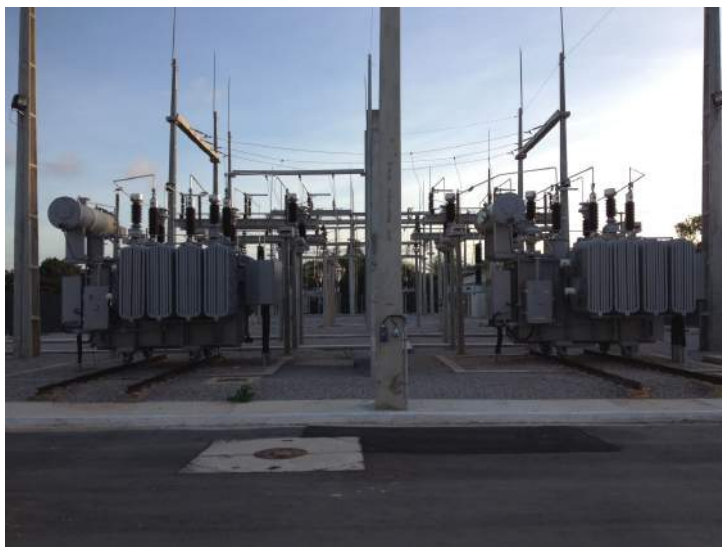
Figura 35 – Subestação utilizada no estudo de caso (Subestação B)
