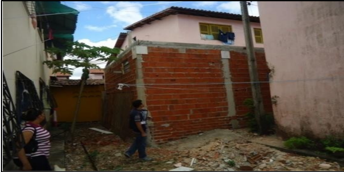
Figuras 24: Apartamentos modificados no conjunto Planalto Universo.
