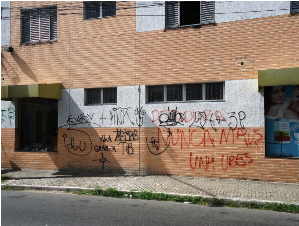
Fotografia 22 – Pixações e pichação , Rua Francisco Pinto
