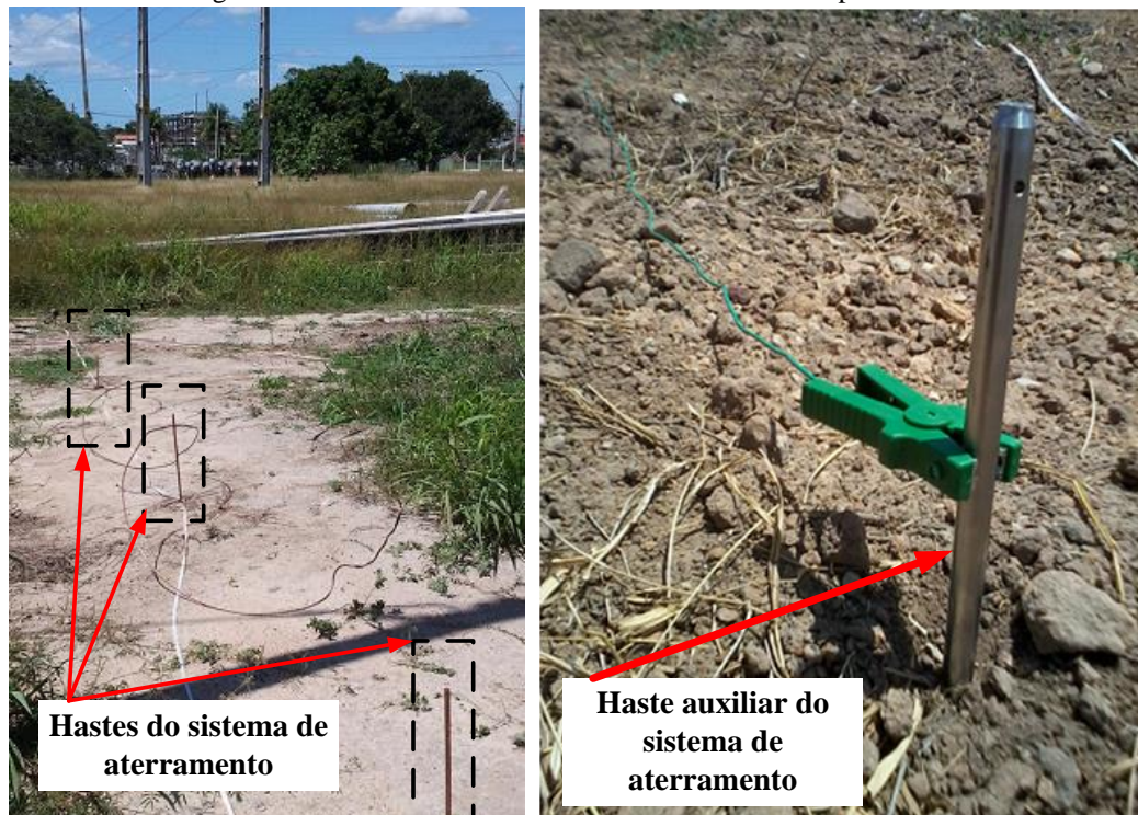
Figura 5.35 – Sistema de aterramento elétrico montado para testes.
