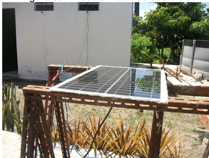
Figura 69 - Módulo instalado sobre o solo
