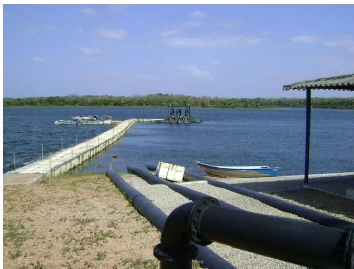
Foto 4.1 - Vista geral do sistema bombeamento
