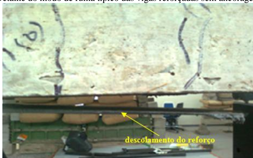
Figura 51 - Detalhe do modo de ruína típico das vigas reforçadas sem ancoragem
