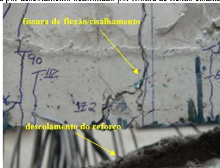
Figura 26 - Ruína por descolamento ocasionado por fissura de flexão/cisalhamento
