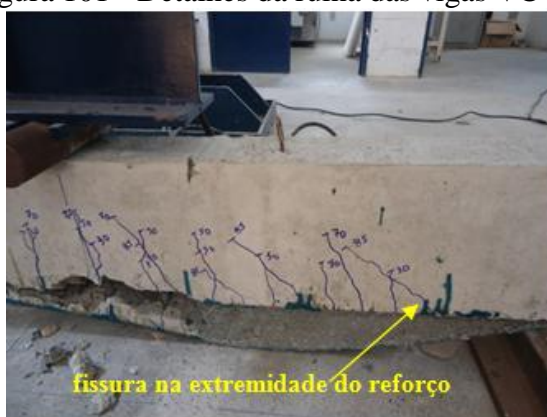
a) fissuras na extremidade do reforço (VC-3)
