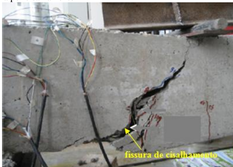
Figura 24 - Ruína por cisalhamento
