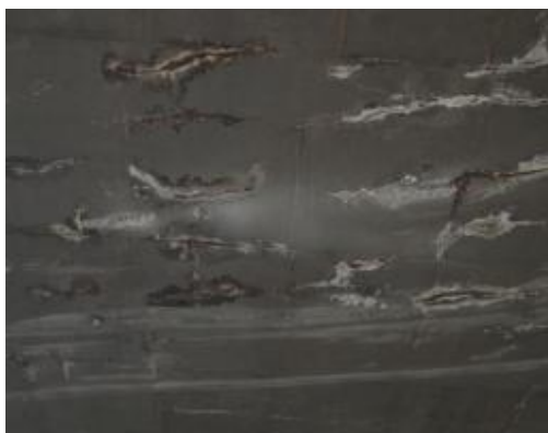
b) fissuração generalizada
