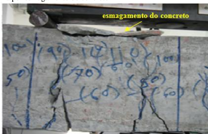
Figura 21 - Ruína por esmagamento do concreto
