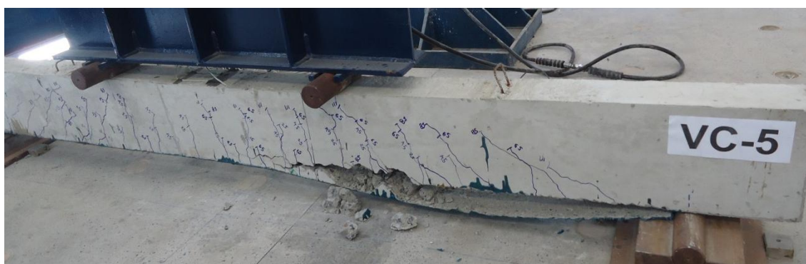
b) configuração da viga VC-5 na ruína
