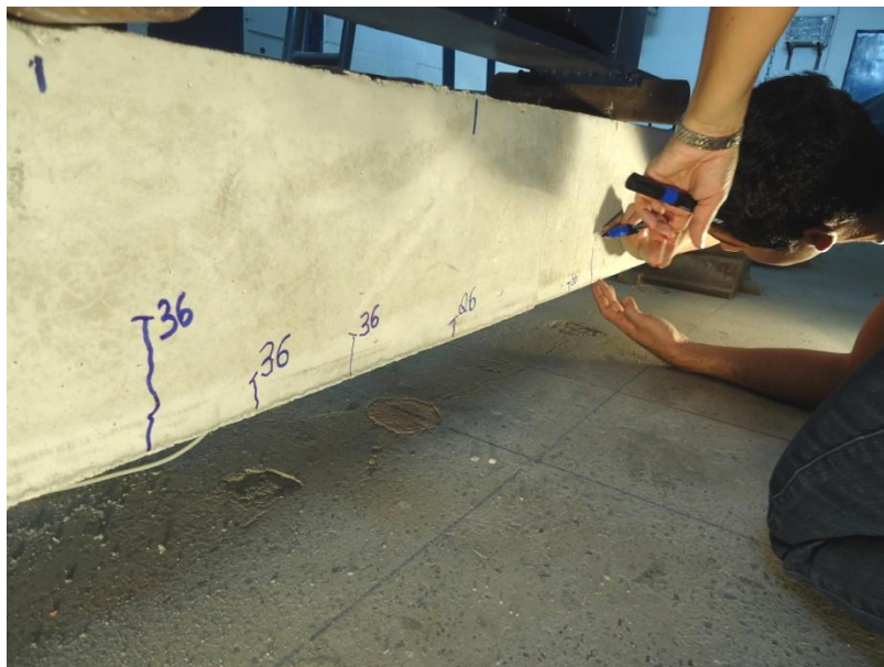
Figura 88 - Monitoramento das fissuras
