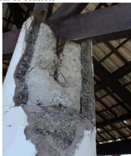
b) desagregação do concreto
