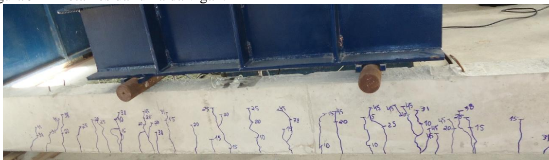
a) configuração da viga VB-R na ruína
