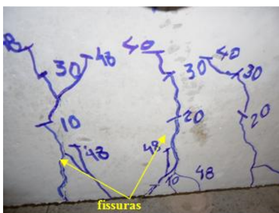
b) fissuras de maiores aberturas
