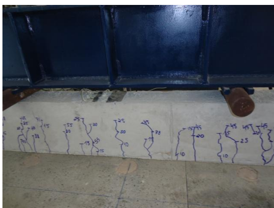
b) fissuras de flexão no meio do vão
