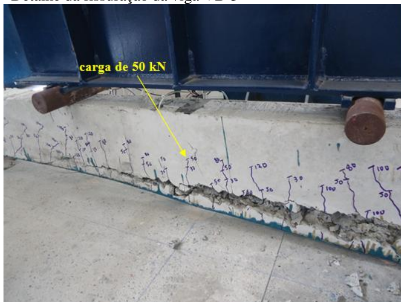
Figura 105 - Detalhe da fissuração da viga VB-5
