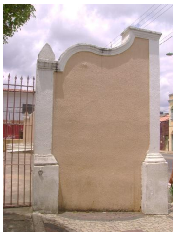
Foto 5.77: Detalhe de arremate do muro da fachada principal Fonte: foto da autora, 2010
