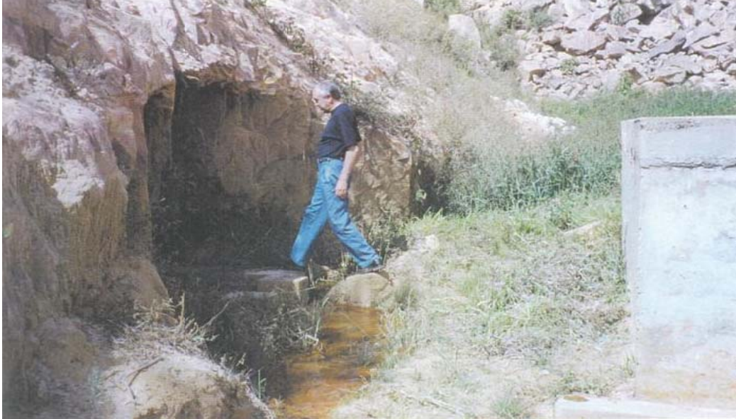
Figura 3.21 - Cava de erosão criada pela surgência na margem direita do canal da Tomada de Água
