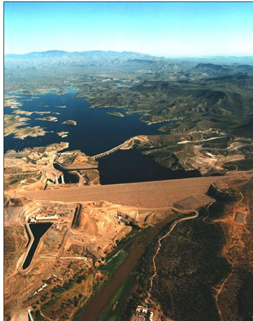
Figura 18 - – Construção da nova barragem de Waddell. Vê-se, à esquerda, planta geradora de energia e a barragem antiga vista por trás da nova.
