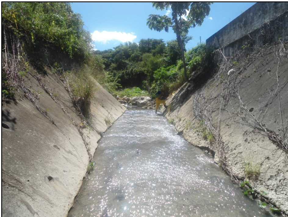
Figura 11: Vista da seção de entrada do canal de alvenaria do Rio Granjeiro
