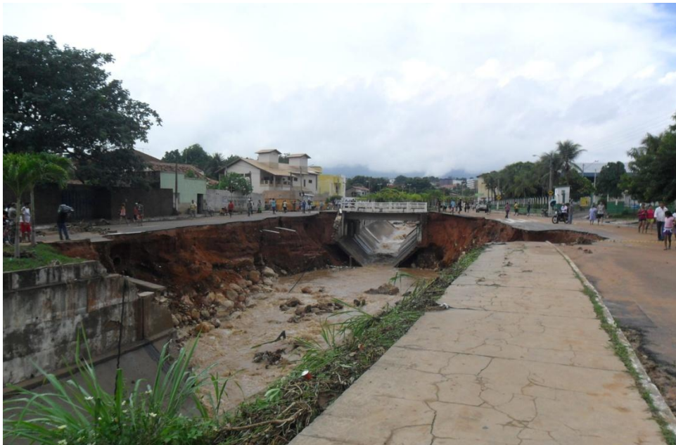
Figura 02: Destruição de trecho do canal do Rio Granjeiro. (Fonte: Autor)
