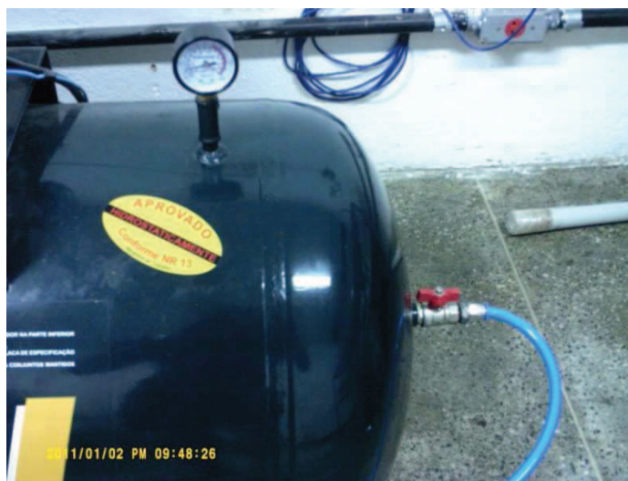
Figura 5.4 – Fotografia da saída do compressor e válvula de esfera
