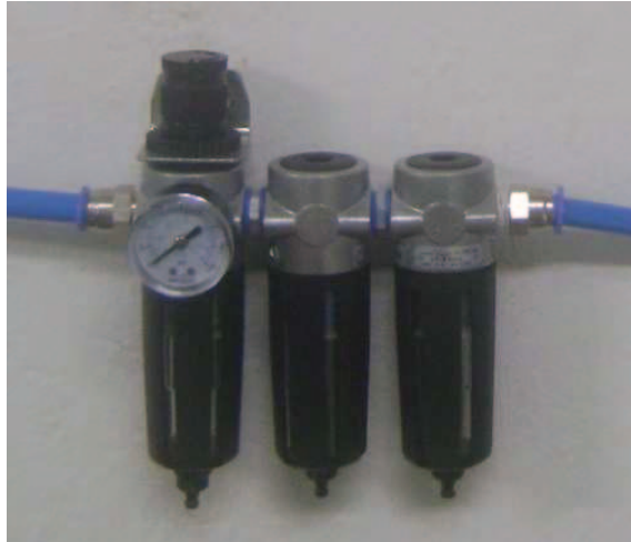
Figura 5.5 – Fotografia da Unidade de Tratamento de Ar
