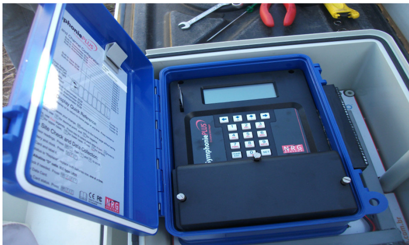
Figura 4.5 - Data logger NRG Symphonie-plus instalado nas torres em estudo.
