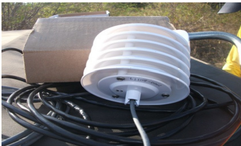
Figura 4.9 – Sensor de temperatura instalado na torre de Maracanaú – CE.
