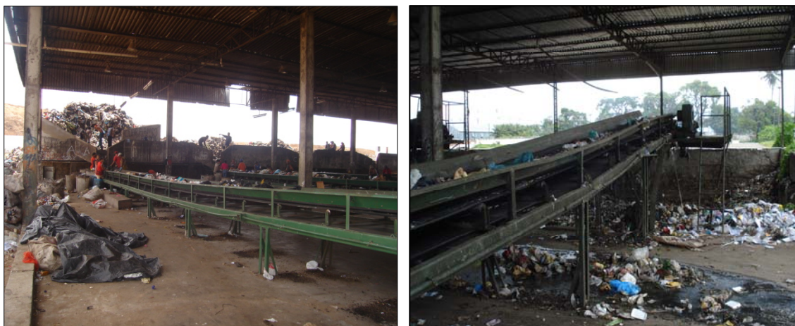
Figura 14 - Vista Parcial de uma Esteira de Usina de Triagem do Jangurussu. Foto do Autor (2008).
