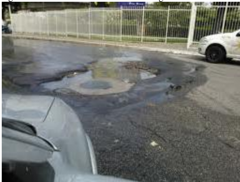
Figura 2.4 – Foto de extravasamento de esgoto
