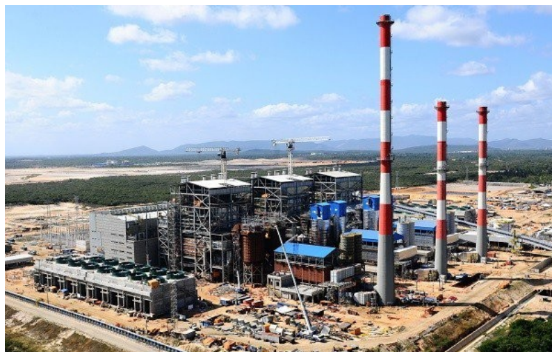
Figura 1 – Usina Termelétrica do Pecém
