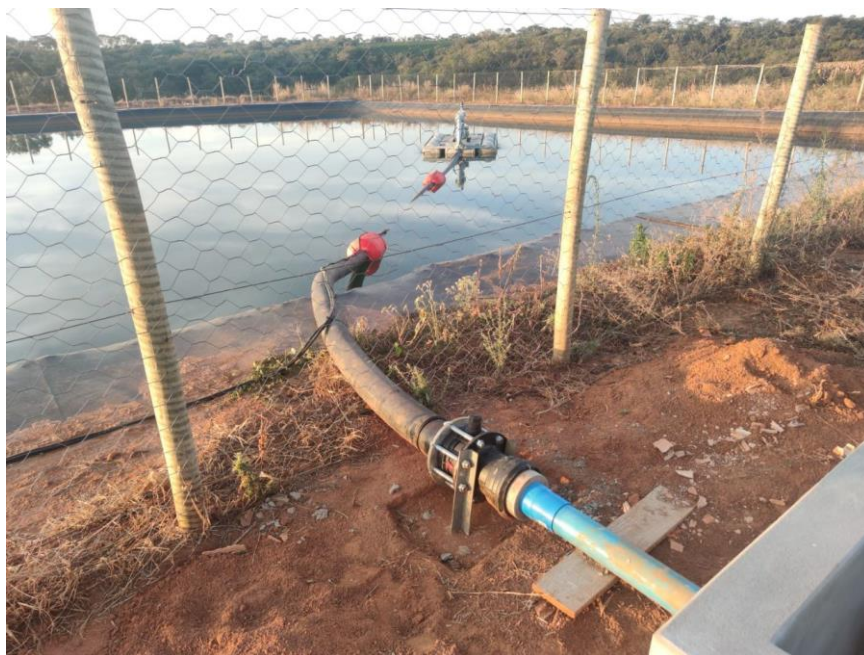
Figura 106 – Saída da adutora após a captação no manancial
