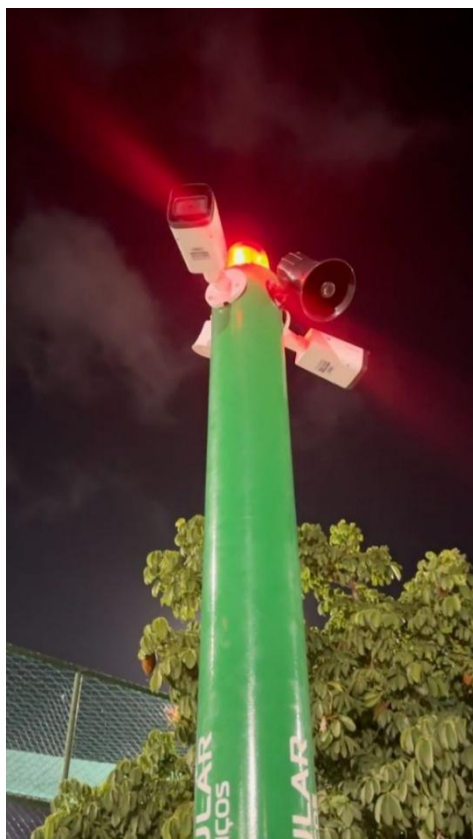
Figura 31— Dispositivo de monitoramento urbano em Fortaleza, utilizado em testes de projetos de segurança pública
