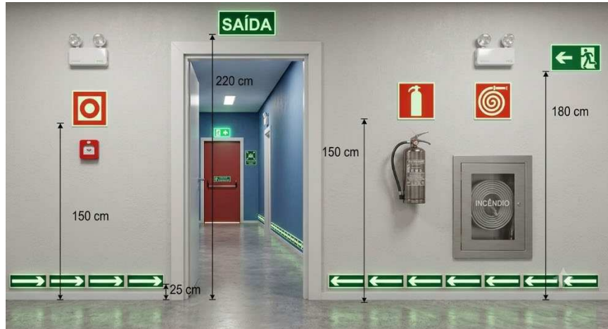
Figura 14: sinalizações de emergência
