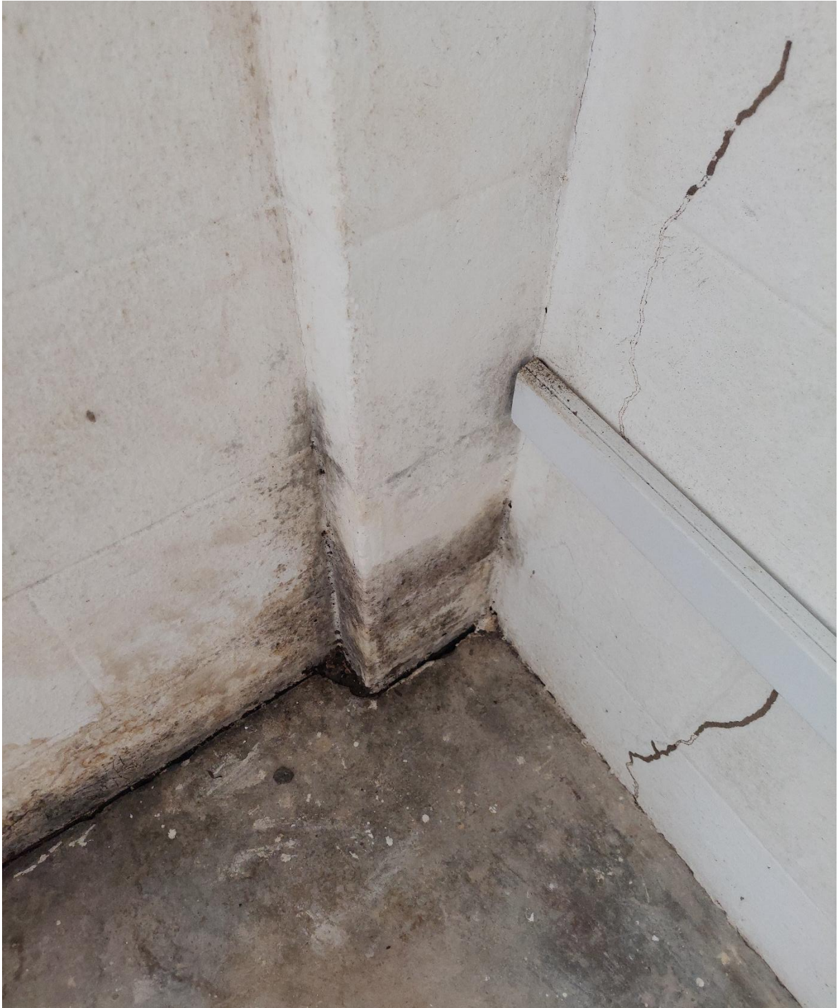
Figura 18 – Presença de infiltrações, rachaduras e cupins na sala 2 do PEAM fotografados em 18 de março de 2026.
