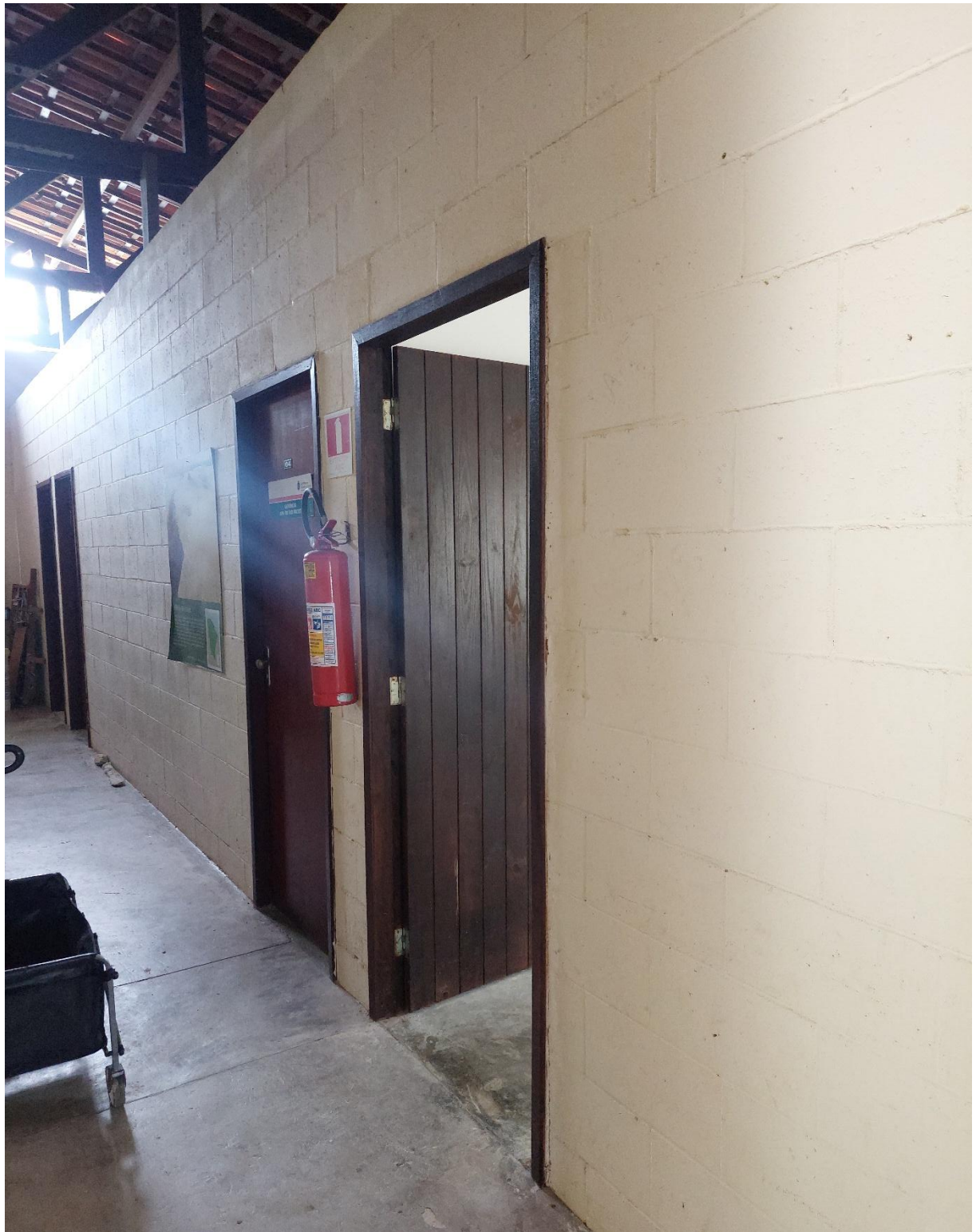
Figura 23 – Único extintor de incêndio presente no galpão principal do CEAC fotografado no dia 18 de março de 2026.
