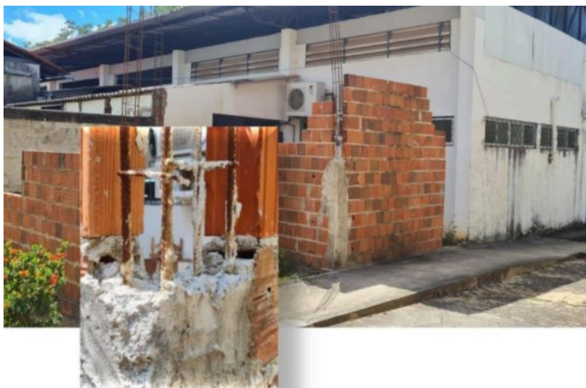
Figura 32 – Exemplo de degradação em obra no campus do Pici
