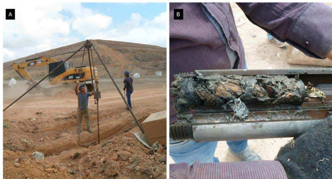
Figura 3 - Sondagens à percussão (SPT) a) Execução b) Coleta de amostra de RSU.
