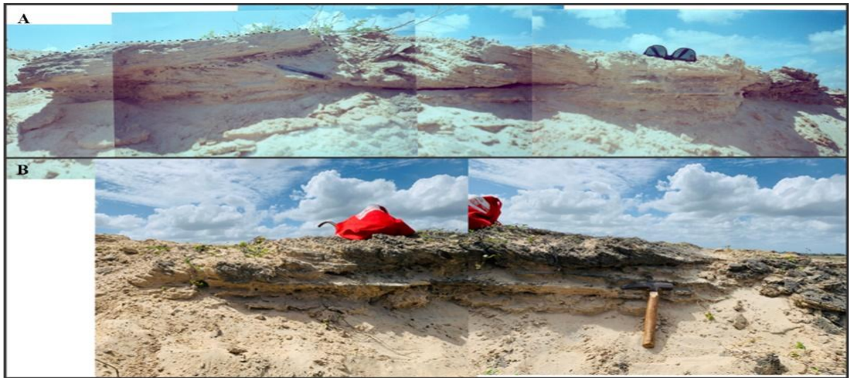
Figura 7 – Afloramento exibindo erosão em Baleia
