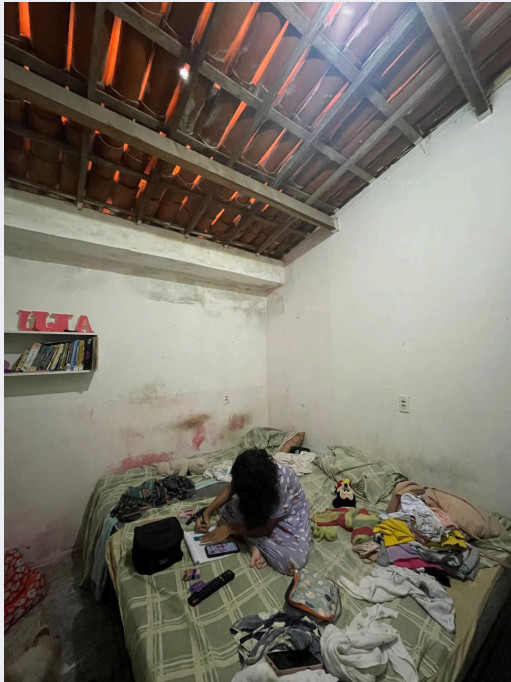
Figura 116: Paredes mofadas no quarto
