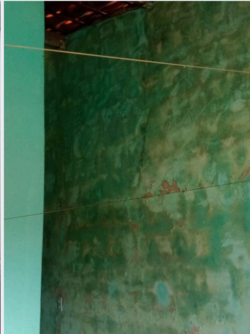
Figura 117: Parede mofada no corredor
