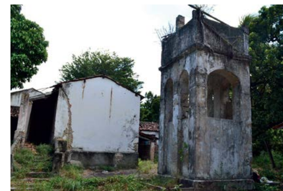
5 fundos da chácara e poço - varanda com coberta em telha colonial danificada e madeiramento exposto, poco com pintura original desgasta - cor branco
