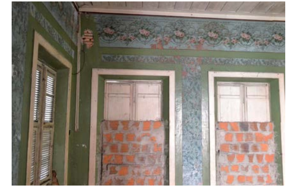
2 Sala de entrada - paredes em pintura parietal original danificada e desgastada, esquadria em madeira pinta cor branca - danificadas e vedadas posteriormente com alvenaria cerâmica.
