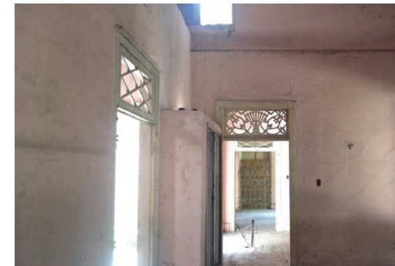
3 Sala interna - pintura original desgastada na cor rosa, esquadrias com pórtico em madeira pintada - cor branca e bandeira metálica - pintada cor branca.
