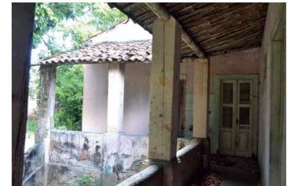
4 Varanda aberta para o parque - colunar e peitoril em pintura original - cor rosa, coberta original desgastada em telha cerâmica, esquadrias originais de madeira com veneziana - pintada cor branca,
