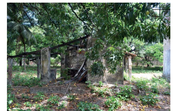
6 Anexo de serviço externo - paredes e coberta deterioras e expostas em avançado estado de degradação.
