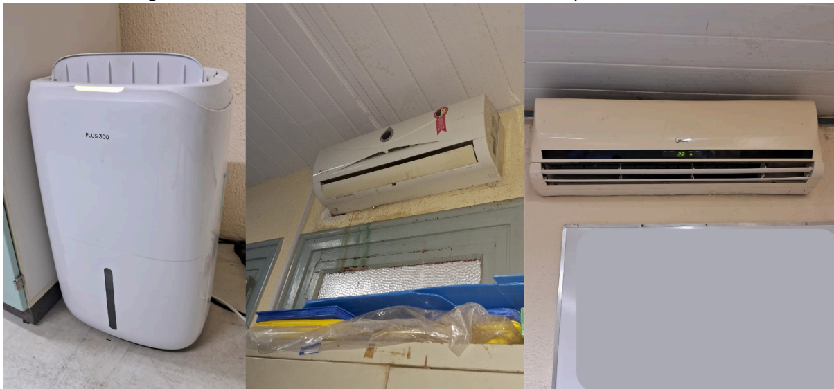
Figura 06 - Desumidificador e ar-condicionados do arquivo do DEGEP
