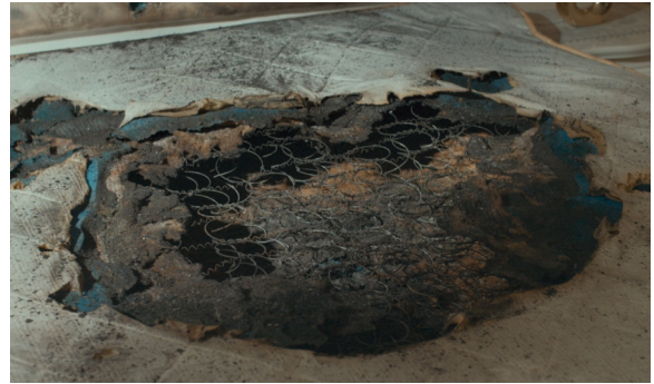
Figura 42 — Detalhe do colchão queimado
