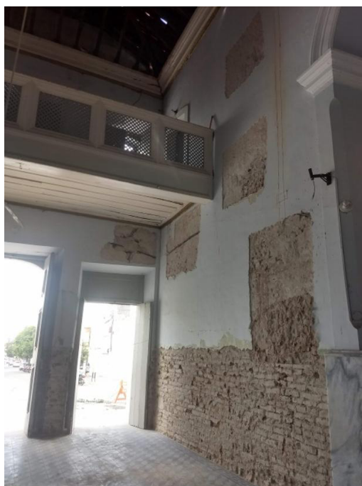
Figura 60: Vista do coro da Igreja do Menino Deus - demolição de revestimentos das paredes
