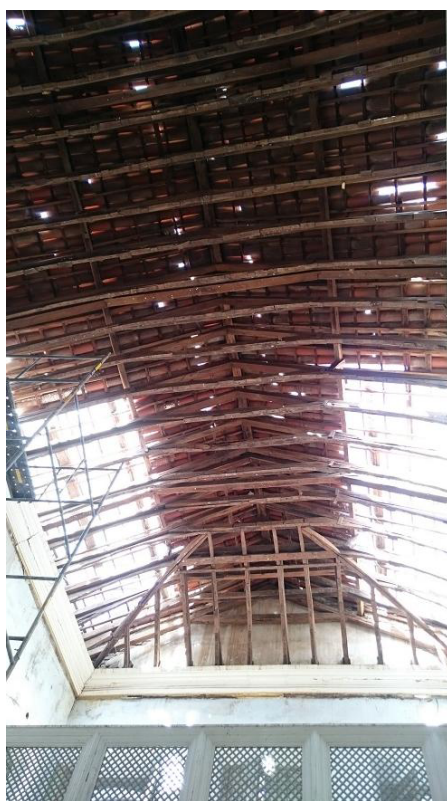
Fonte: Relatório de vistoria realizada em 09/09/2020 – ET-Sobral/IPHAN
