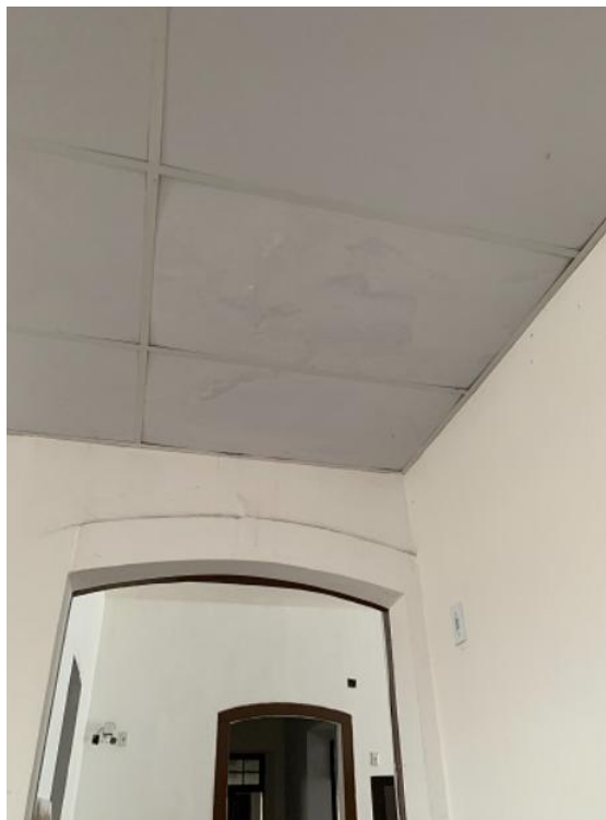
Figura 126: Vista do forro em placas de gesso localizado na área central da edificação com destaque para infiltração
