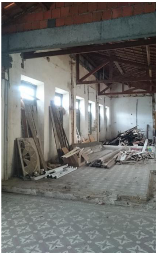
Fonte: Fiscalização ET-Sobral (PARECER TÉCNICO nº 8/2021/ETS-CE/IPHAN-CE), vistoria realizada em fev/2021
