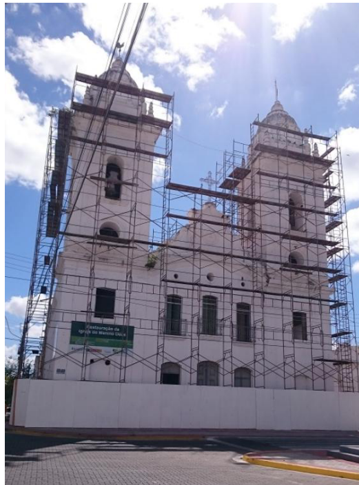
Figura 62: Fachada da Igreja Menino Deus com andaimes, tapume de chapa compensada e placa de obra.
