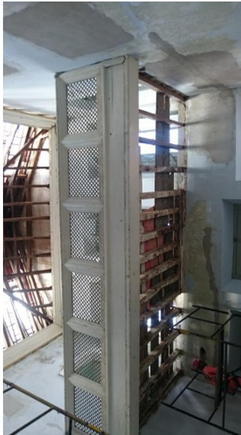
Figura 68: Coreto com remoção de piso de madeira em 2020
