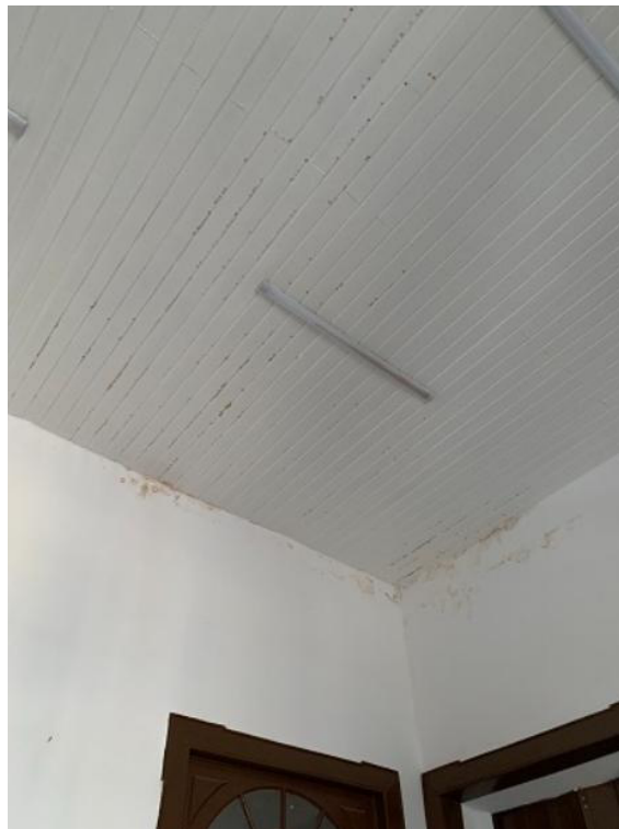
Figura 125 : Vista do forro em lambri de madeira localizado na área central da edificação com destaque para infiltração
