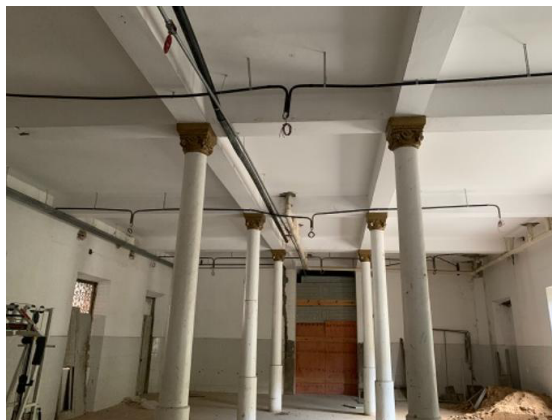
Fonte: vistoria realizada pelo ETS/IPHAN-CE, AGOSTO/2024 (NOTA TÉCNICA nº 63/2024/ETS-CE/IPHAN-CE)
