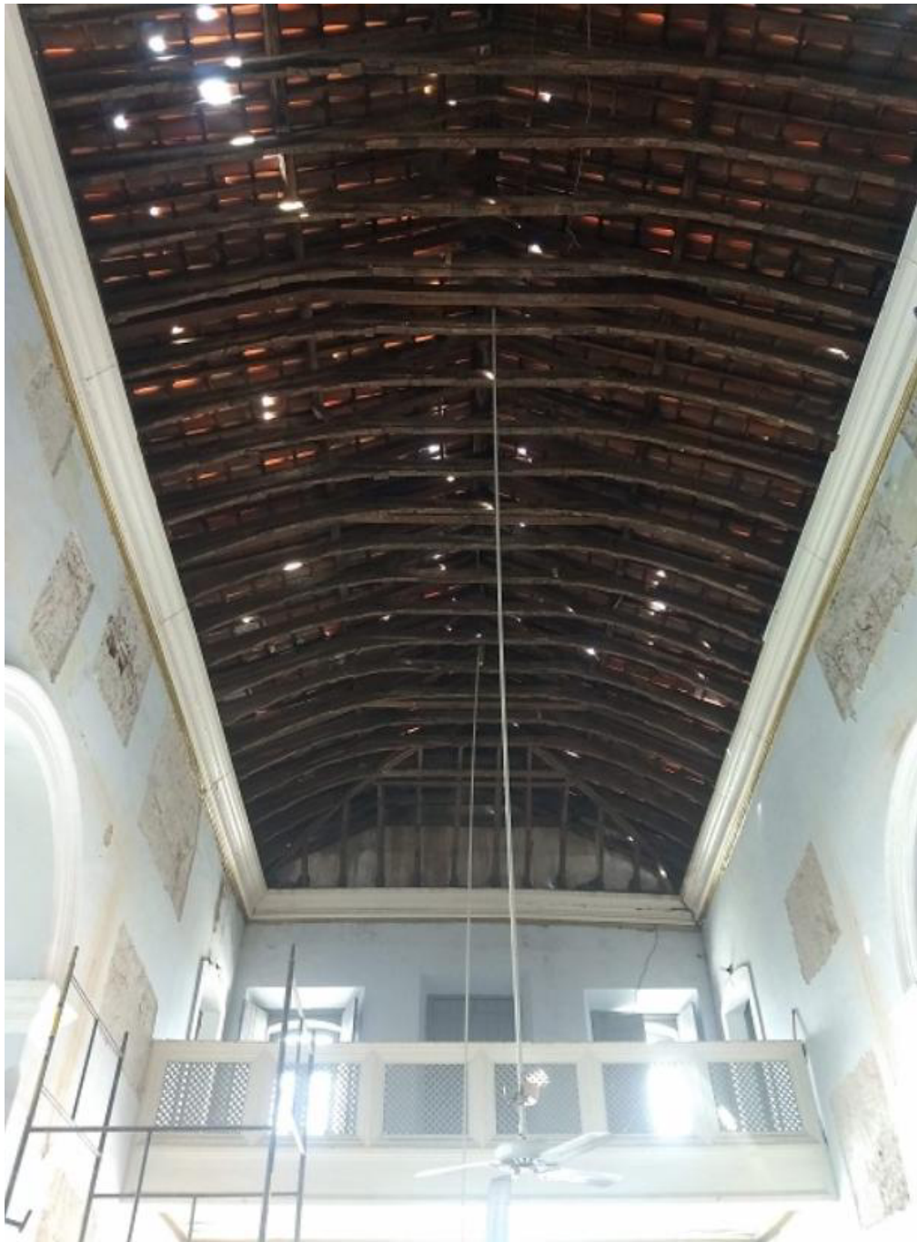
Fonte: Vistoria realizada em 06/03/2020 pelo Escritório Técnico do IPHAN de Sobral
