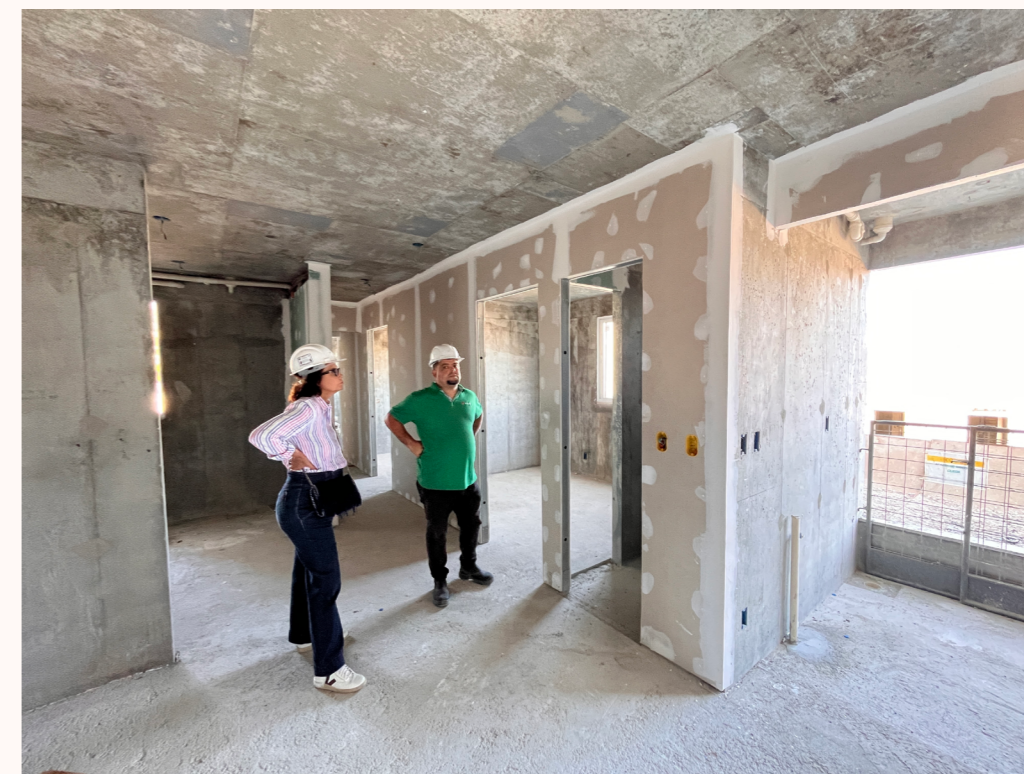
Figura 05-03.4 – Montagem de vedações internas em "light steel frame" e placas de gesso acartonado
