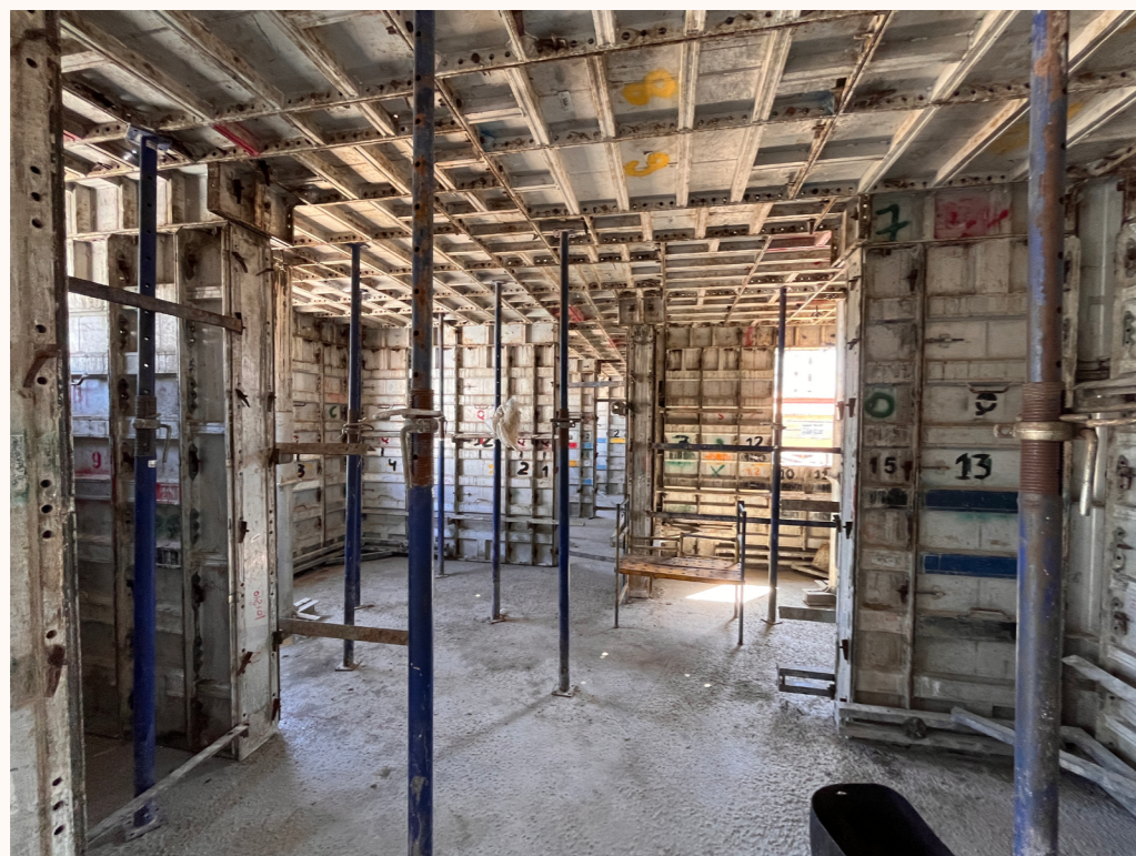
Figura 04-03.4 – Interior de unidade habitacional durante processo de concretagem de paredes de concreto
