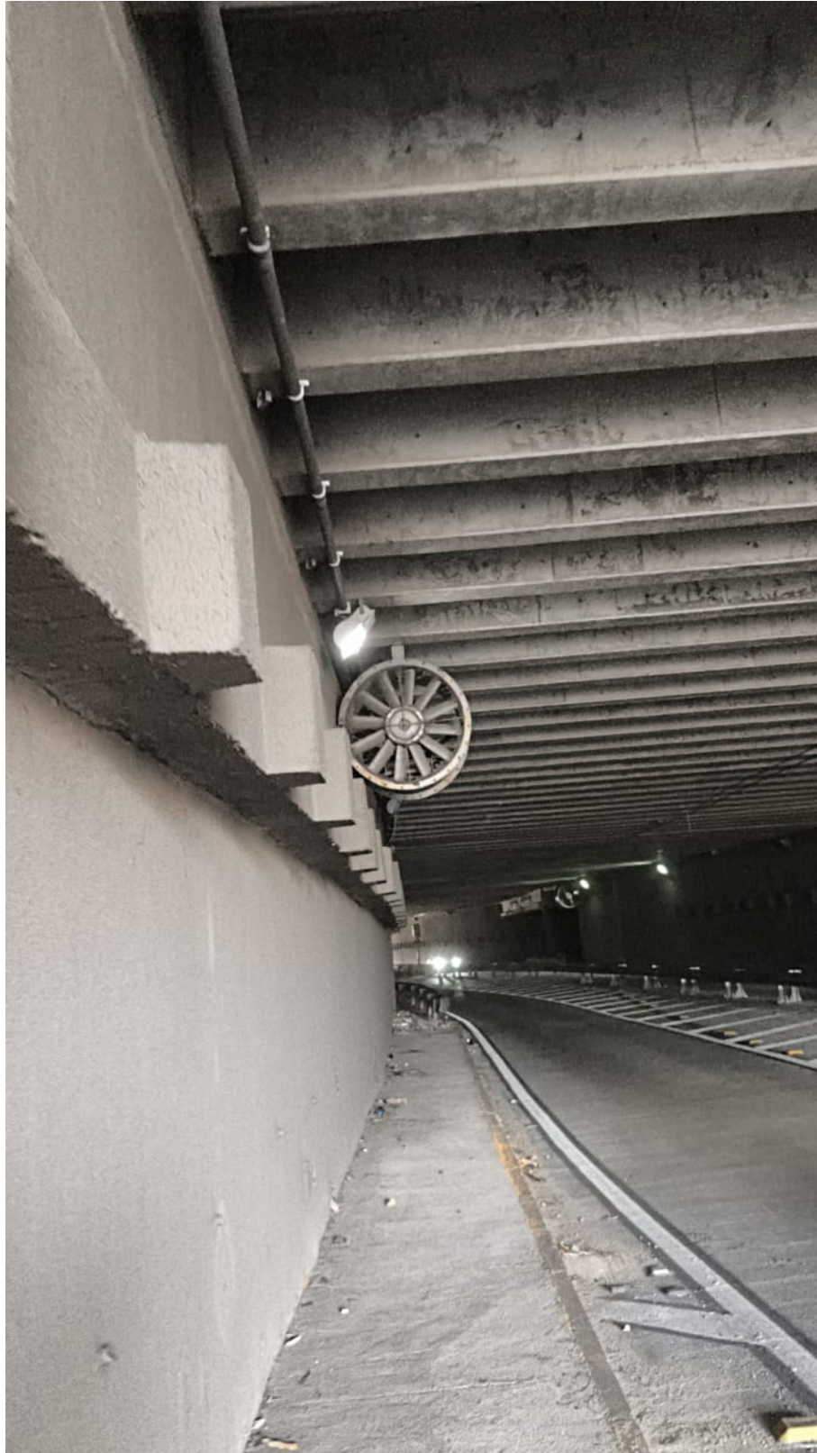
Figura 36 – Exemplo de ventilação mecânica no interior do Túnel Sérgio Nogueira.
