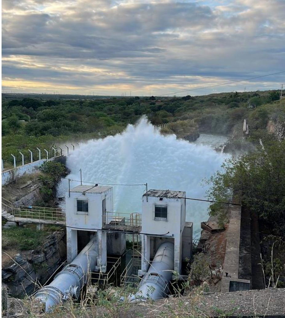
Figura 43 – Central Geradora Elétrica Armando Ribeiro Gonçalves em Itajá
