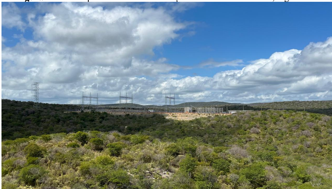
Figura 41 – Vista panorâmica da Subestação em Santana do Matos, região leste
