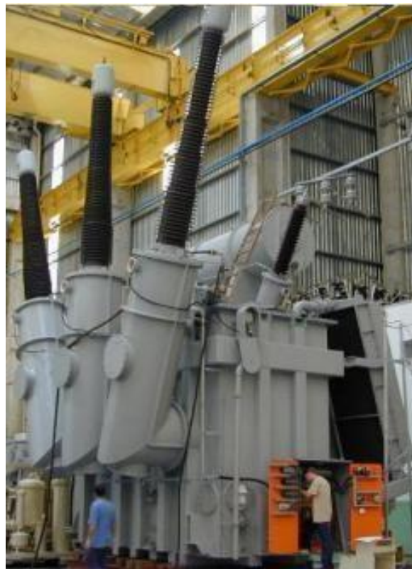
Figura 04 - Transformador trifásico imerso em óleo isolante
