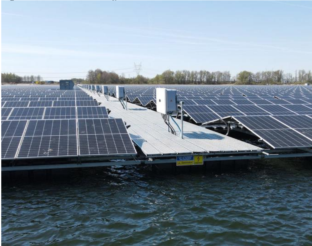
Figura 16 – Inversores string instalados em estruturas flutuantes
