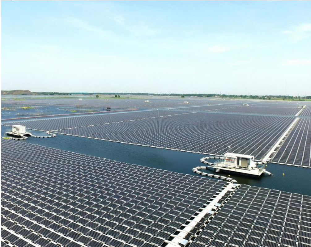
Figura 17 – Centrais inversoras flutuantes
