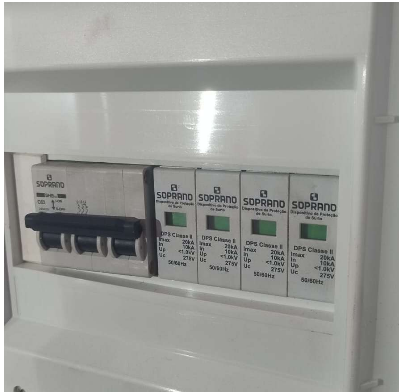
Figura 13 - Quadro de Proteção CA do Inversor
