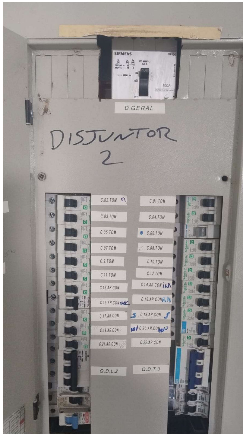
Figura 9 - QGBT da Unidade Geradora
