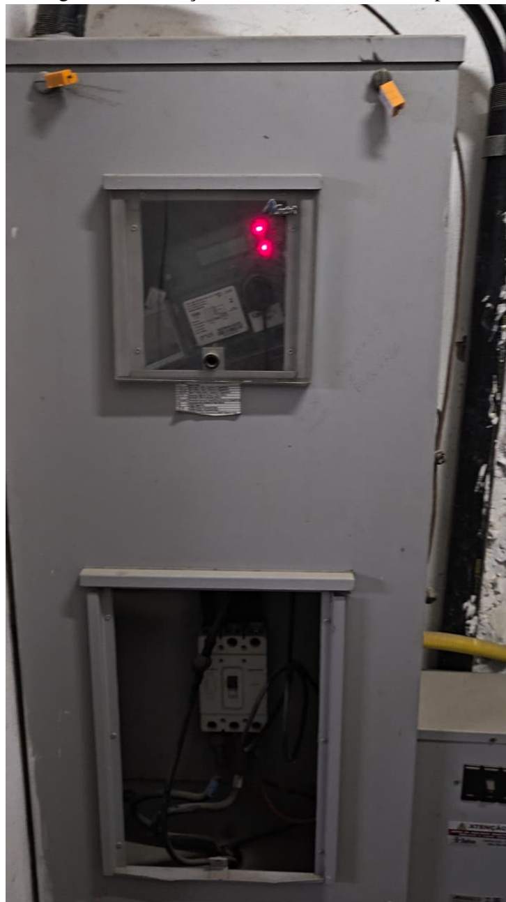
Figura 8 – Situação do medidor atual da empresa.
