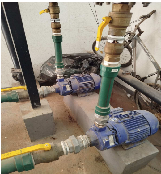
Figura 7 : Motores de recalque
