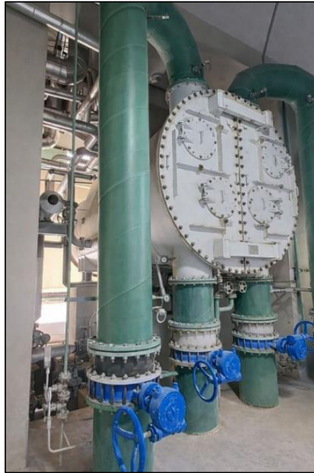
Figura 15 – Condensador de vapor da Unidade
