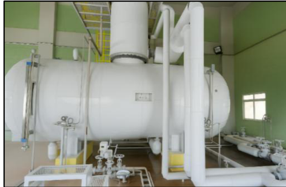
Figura 18 – Desaerador de água da Unidade
