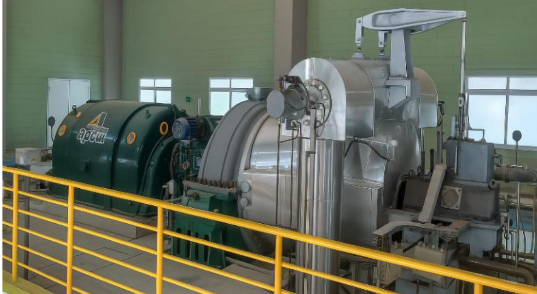
Figura 14 – Turbina a vapor e Gerador de energia da Unidade
