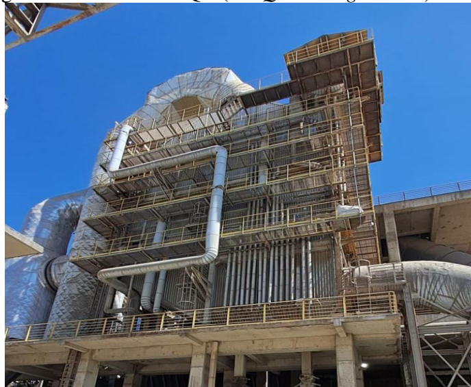
Figura 11 – Caldeira AQC ( Air Quenching Cooler ) da Unidade
