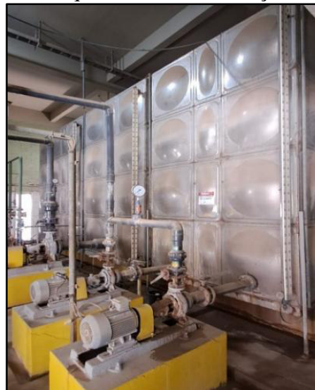
Figura 19 – Tanque de desmineralização da Unidade
