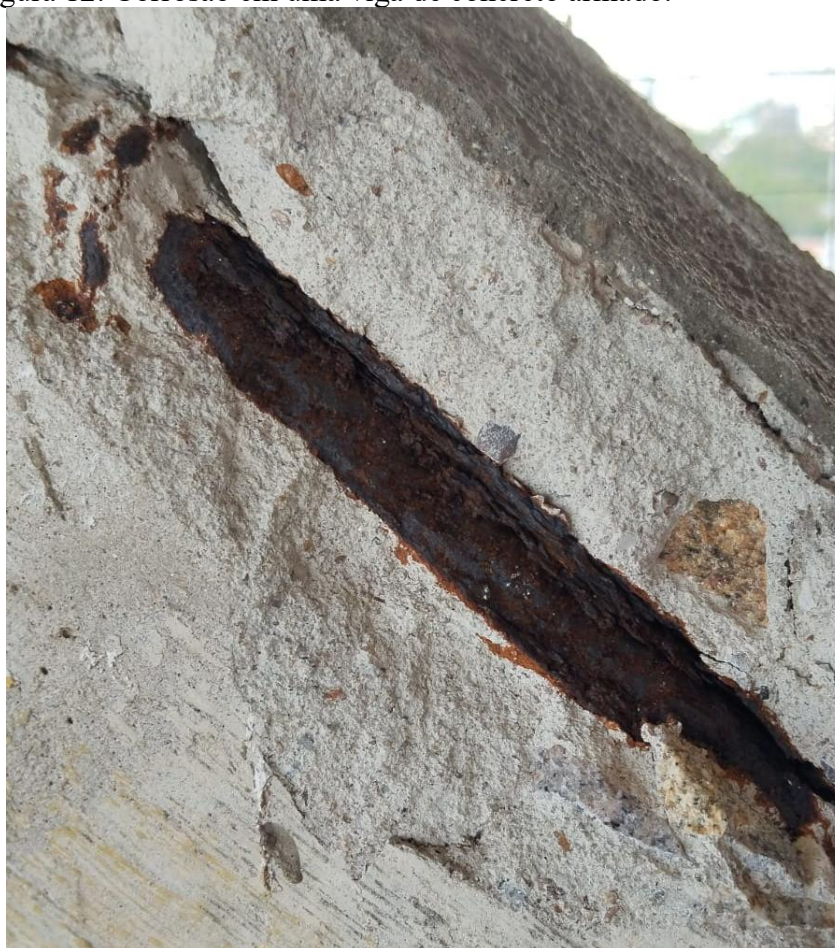
Figura 12: Corrosão em uma viga de concreto armado.
