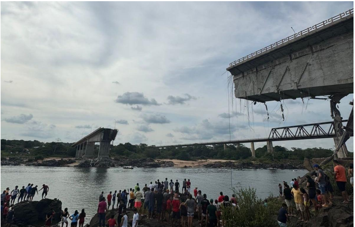
Figura 04: Queda da Ponte JK, na fronteira entre os estados de Tocantis e Maranhão.
