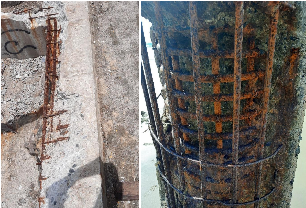
Figuras 23 a 25: Manifestações patológicas encontradas durante a inspeção técnica.
