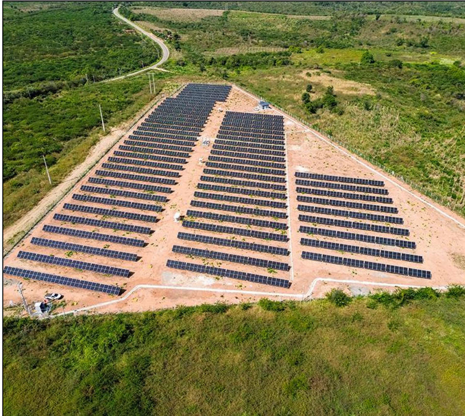
Imagem 04 – Foto da usina de Minigeração Distribuída “UFV Ipú”, de 1MW de potência, desenvolvida pela Trinity Energias Renováveis.
