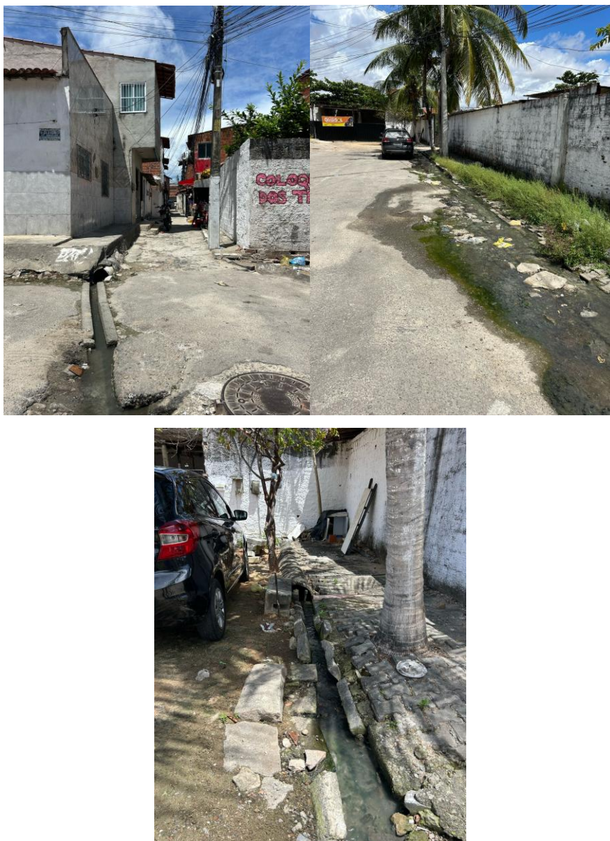
Figura 38 - Esgoto a céu aberto na Z2.
