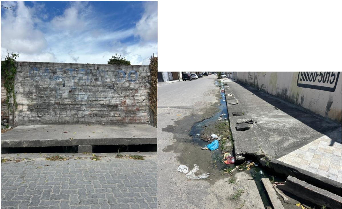
Figura 42 - Elementos de drenagem urbana na Z2.
